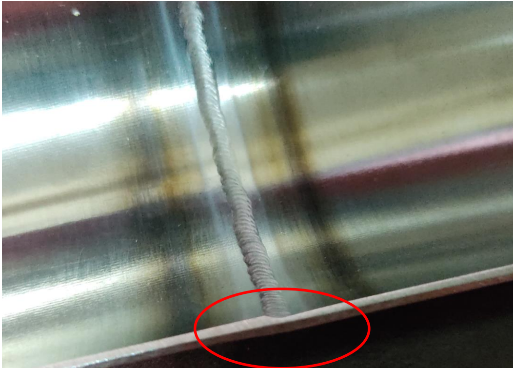
Figura 49. Defecto de desalineamiento.
