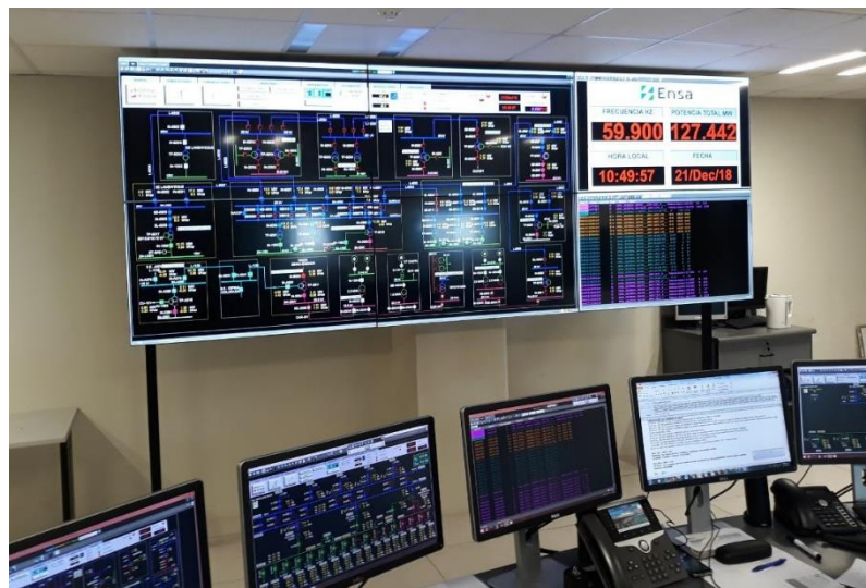
Figura 5.3 Centro de Control SCADA.
