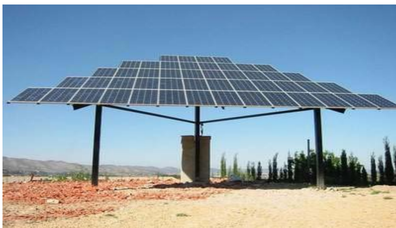
Figura 3.21 Panel solares usados en telecomunicaciones
