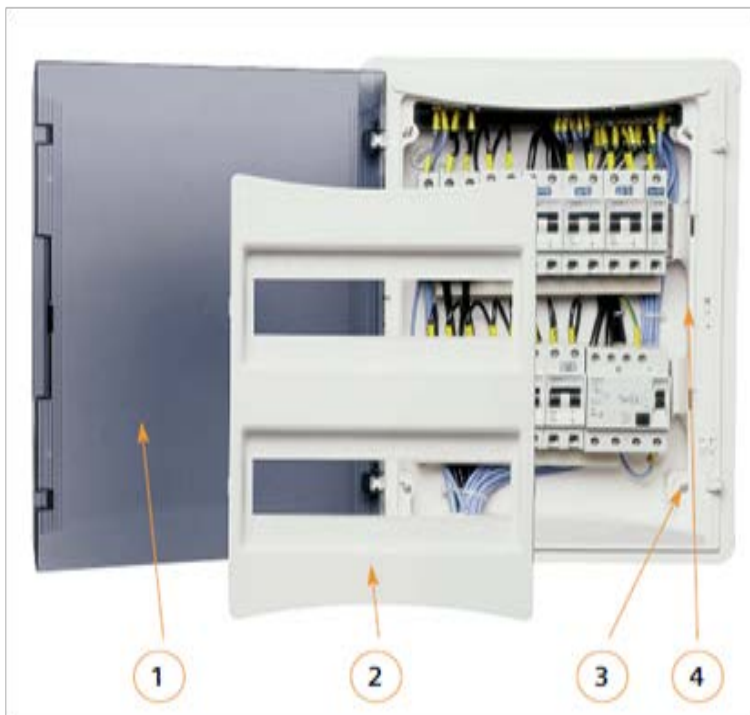
Figura 3.23 Tablero de distribución
