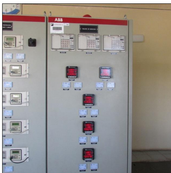
Figura 2.6 Tablero digital de medición de otra subestación de referencia
