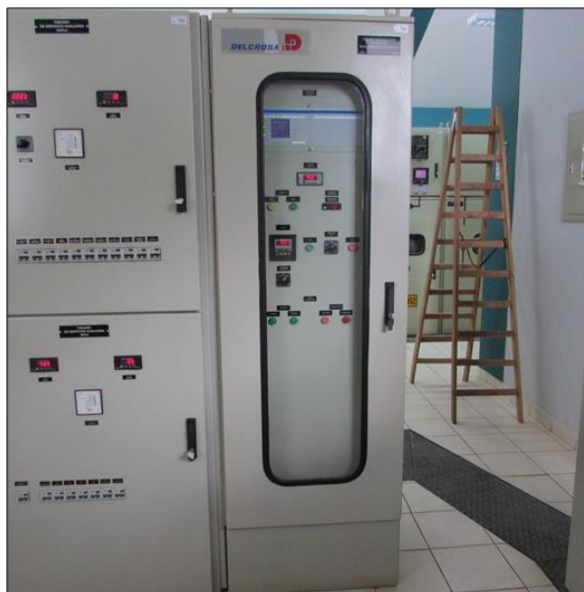
Figura 2.8 Tablero de Regulación de Voltaje de una subestación de referencia
