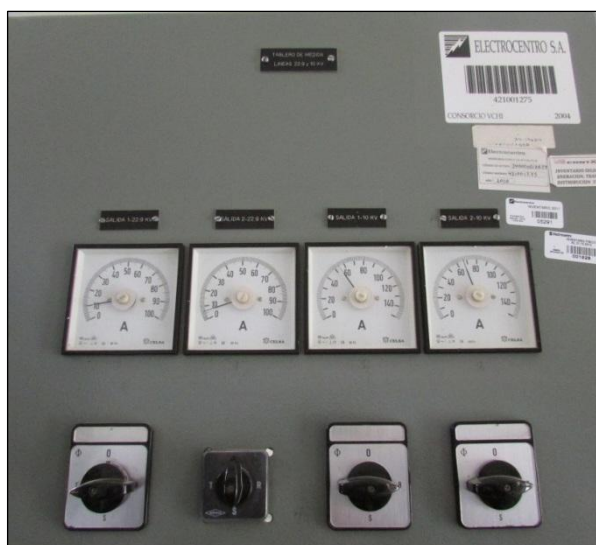
Figura 2.5 Tablero analógico de medición de la subestación de referencia.
