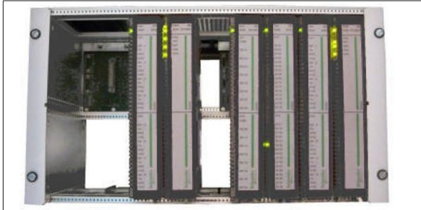
Figura 2.17 Módulos instalados en un backplane de 9 slots.
