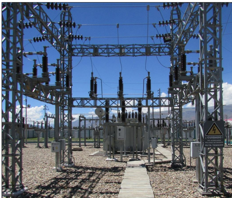
Figura 2.1 Patio de llaves referencial de una subestación.
