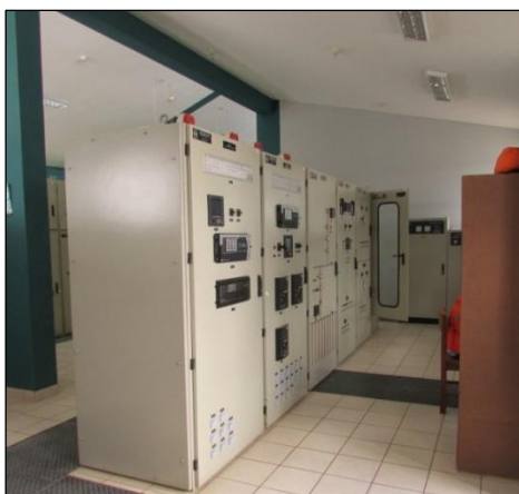
Figura 3.62 Subestación de referencia
