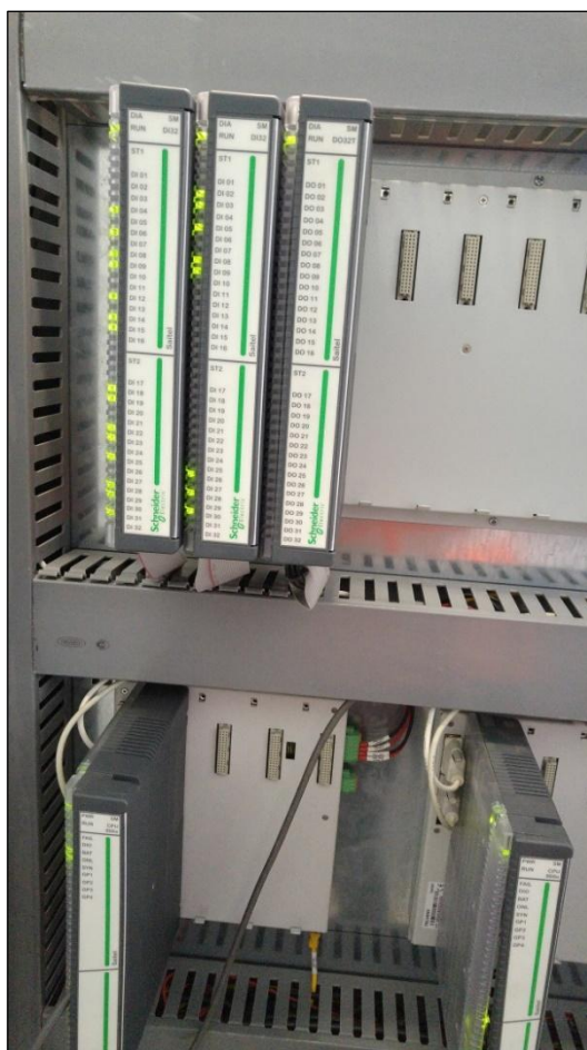
Figura 3.65 CPU y módulos E/S del tablero CDS de la subestación de referencia
