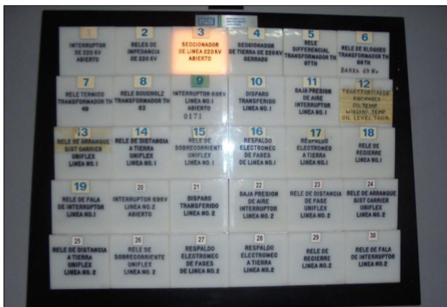
Figura 2.7 Panel Anunciador de una estación de referencia.
