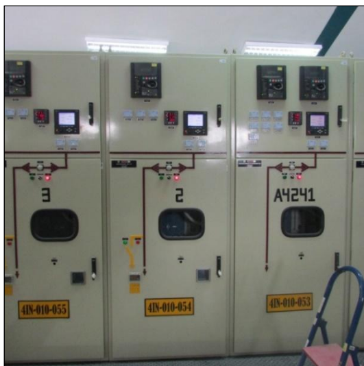
Figura 3.64 Celdas de llegada de la subestación de referencia
