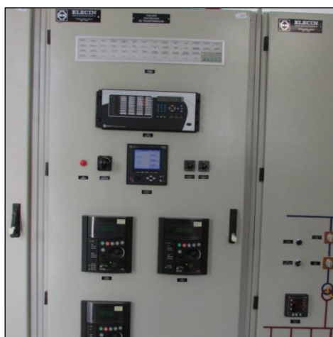
Figura 3.63 Tablero de protección de transformador de la subestación de referencia
