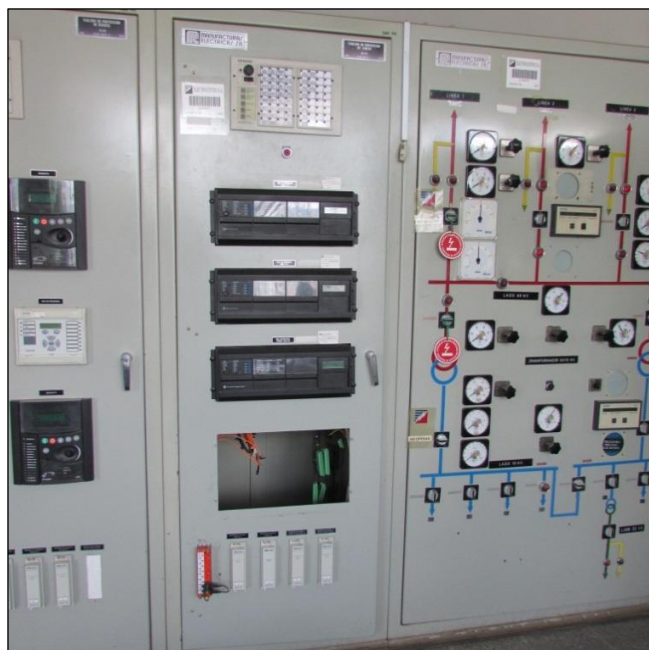
Figura 2.4 Tablero de Protección de Línea 60 KV de la subestación de referencia.
