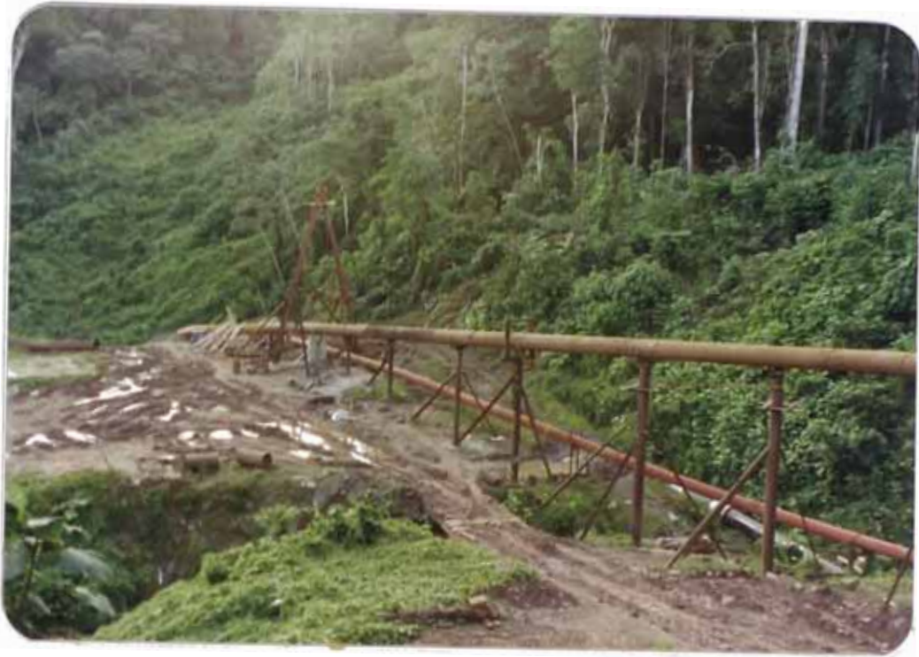
FIG. 2.- Vista en la que se observan la margen derecha de la tubería de reemplazo sobre el falso puente y la tubería by-pass.
