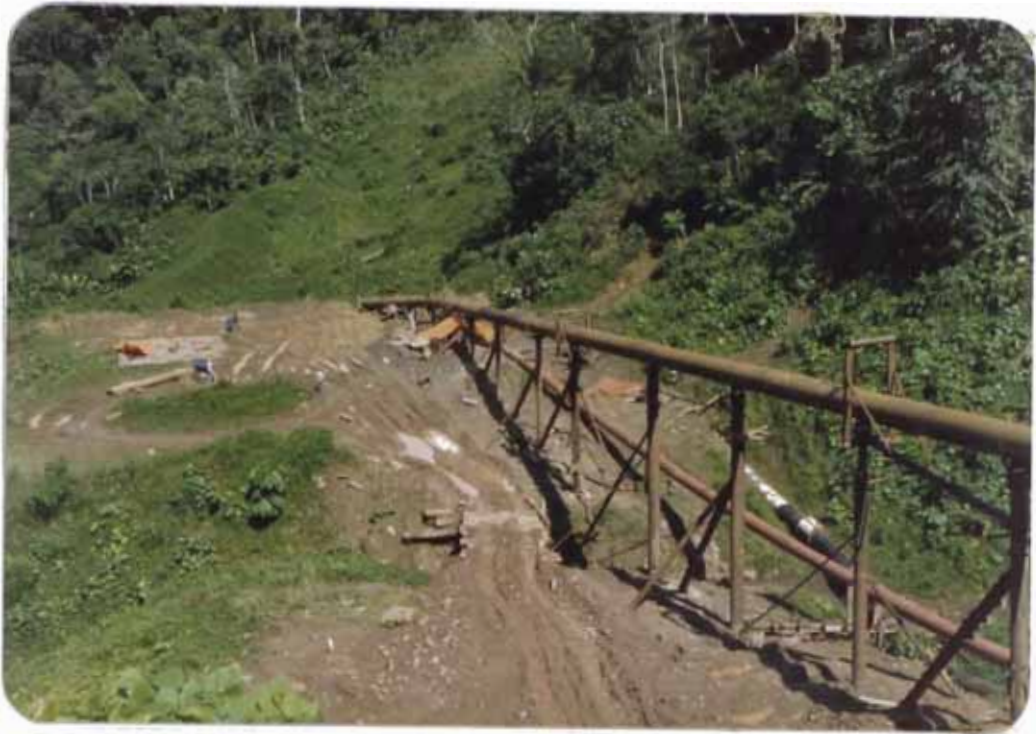
FIG. 4.- Vista de la margen derecha, se observa el dobléz en la tubería de reemplazo y la tubería del Oleoducto con algunas reparaciones (parte blanca).
