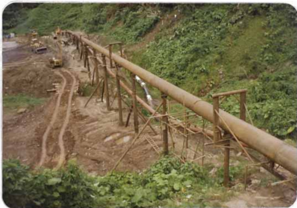
FIG. 5.- Vista del tramo recto de la tubería de reemplazo (100 m.).
