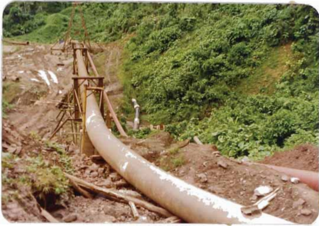
-FIG. 6.- Vista de la margen izquierda, puede apreciarse el dobléz en la tubería de reemplazo.
