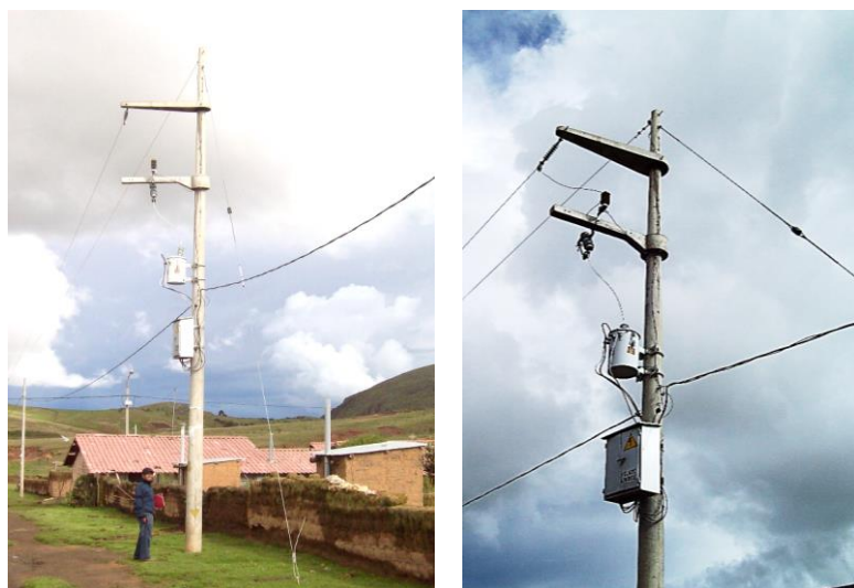
Figura 29. Vista del transformador de distribución monofásico de 5 kVA localizado en la comunidad de Raymina.
