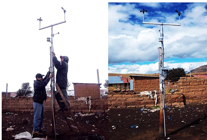
Figura 44. Imágenes de la Estación Meteorológica Hobo instalada (CER-UNI, 2012).
