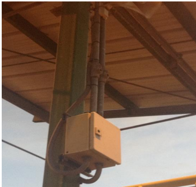
Figura 28. Equipo de radio frecuencia (Fuente Repsol).
