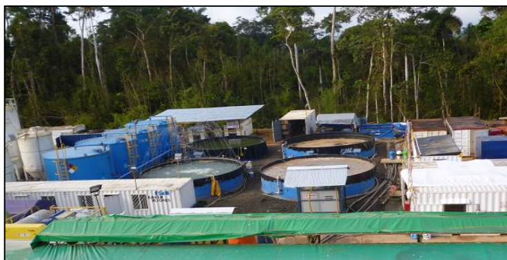
Figura 3.8. Sistema de Tratamiento de agua con tanques australianos típicos en un pozo petrolero.
