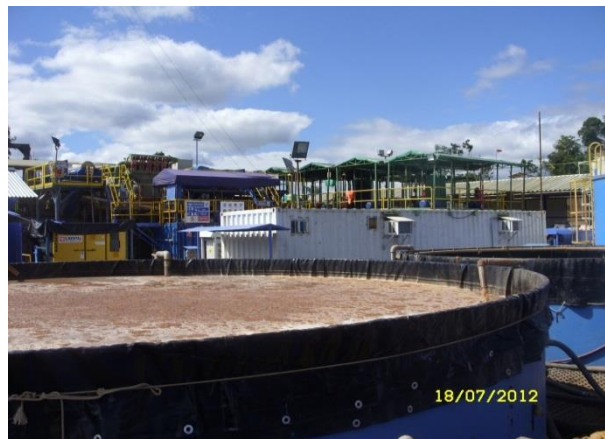
Figura 1.3. Almacenamiento del efluente en Tanques Australianos, durante la actividad de Perforación.
