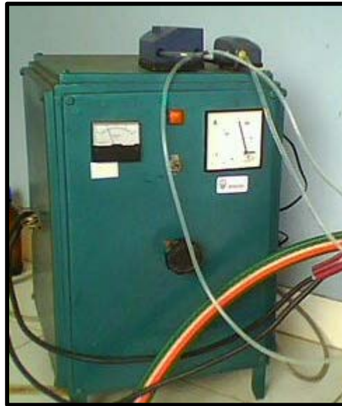
Figura 44: Rectificador de corriente continua de regulación fina usado en experimentos con Reactor flujo continuo. Voltaje 0 – 10v. Capacidad 0 – 100 A.
