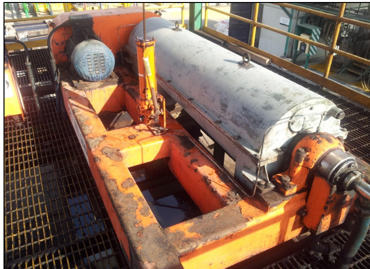
Figura 2. 43. Decantador centrífugo de la planta de tratamiento de aguas aceitosas.
