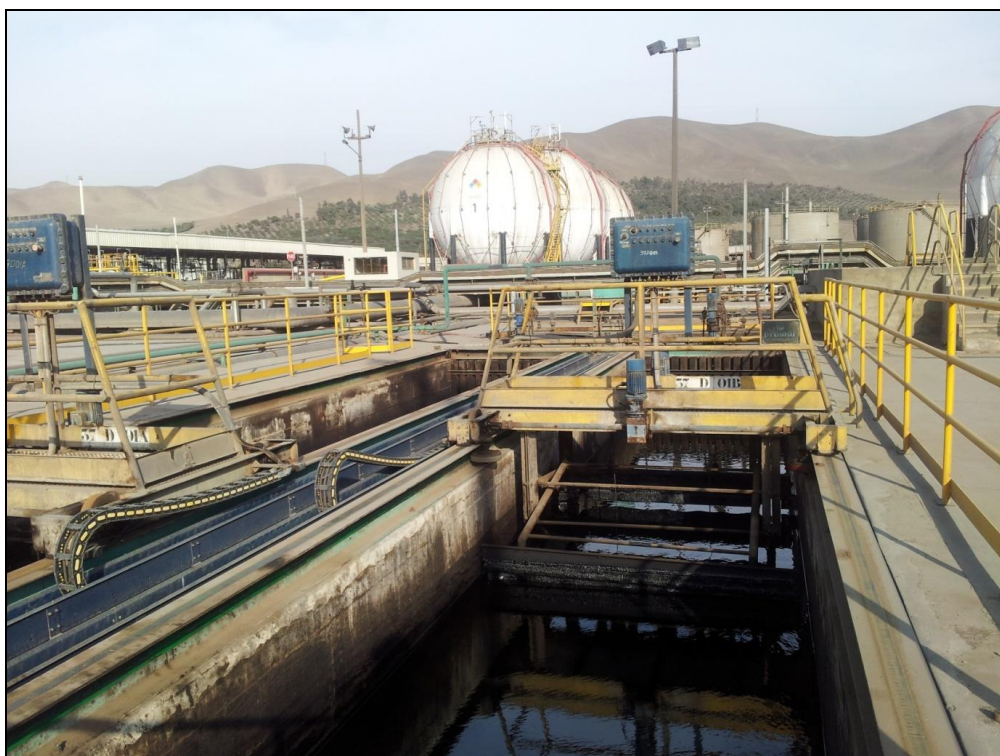
Figura 2. 8. Separador API de la planta de tratamiento de aguas aceitosas.
