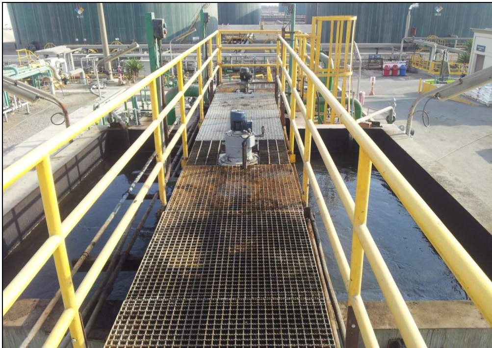
Figura 2. 13. Unidad de floculación de la planta de tratamiento de aguas aceitosas.
