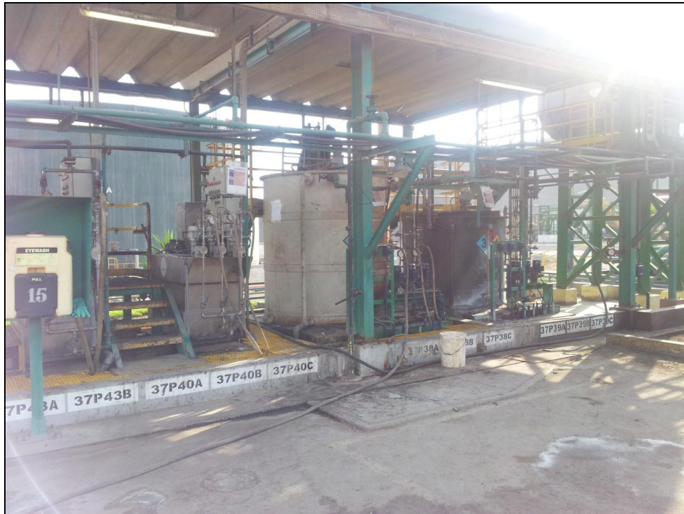
Figura 2. 24. De izquierda a derecha, Cubetas de coagulante, deshidratante, floculante y Soda Caústica.
