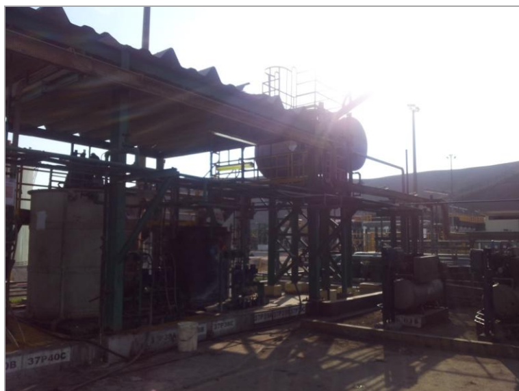
Figura 2. 27. Drum de almacenamiento de soda cáustica
