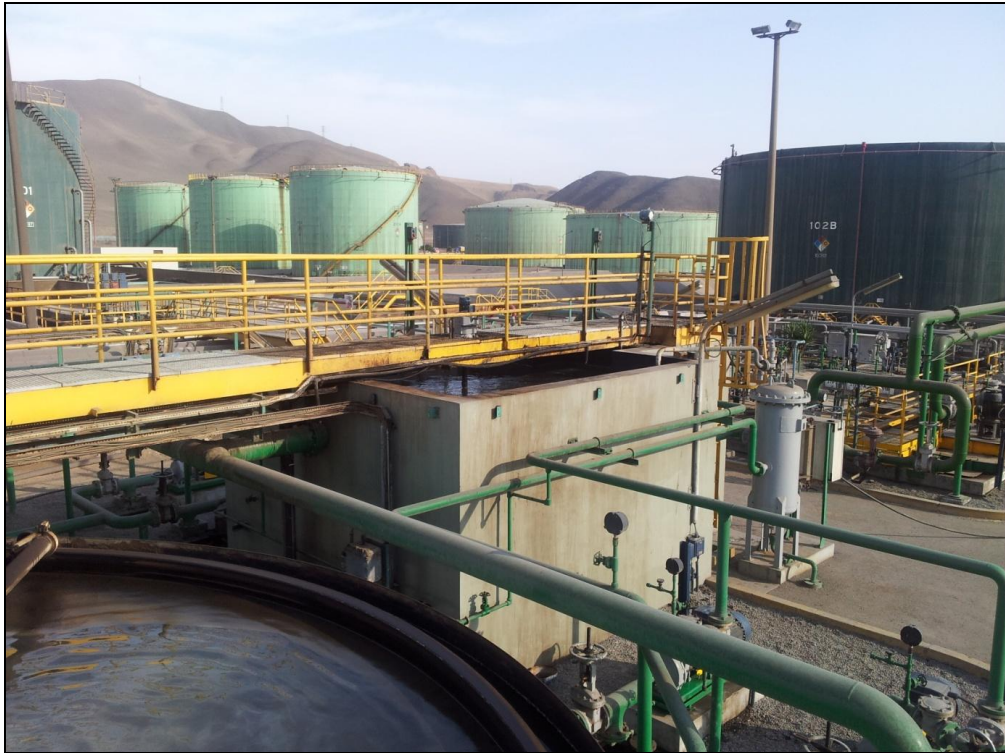
Figura 2. 25. Arquetas de coagulación y floculación
