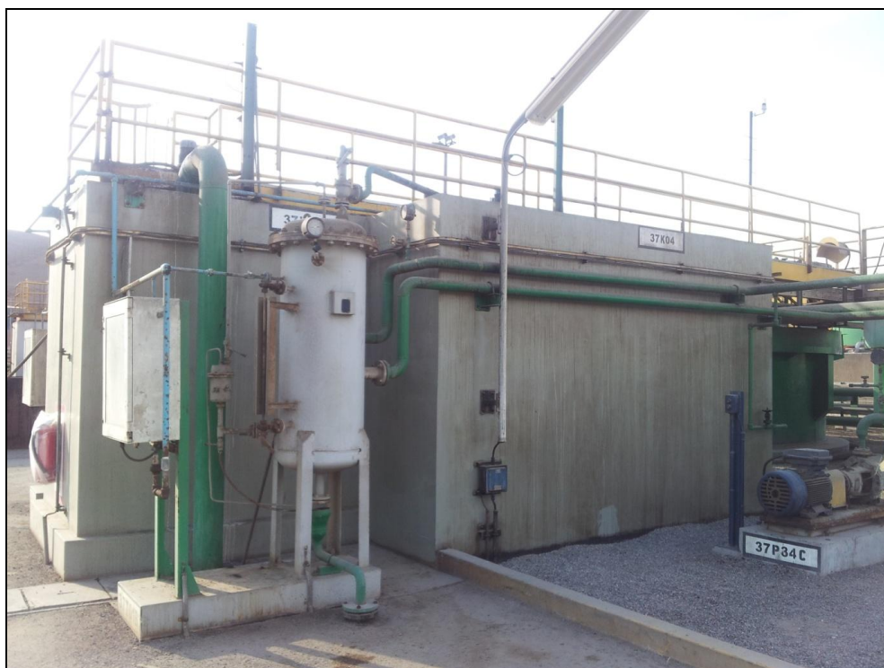
Figura 2. 14. Unidad de flotación por aire disuelto de la planta de tratamiento de aguas aceitosas.
