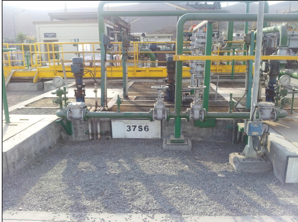
Figura 2. 12. De la planta de tratamiento de aguas aceitosas.
