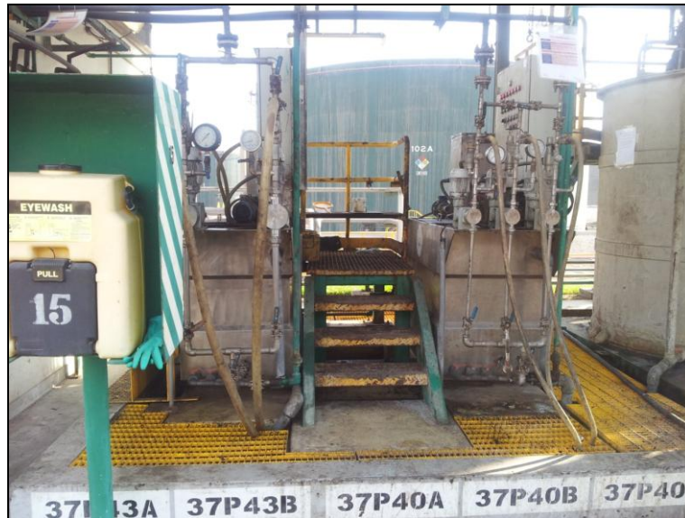
Figura 2. 29. De la planta de tratamiento de aguas aceitosas.
