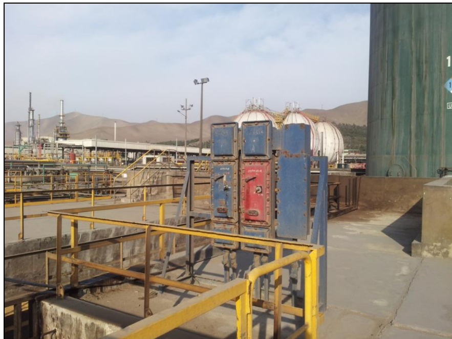
Figura 2. 22. Borneras del CPI de la planta de tratamiento de aguas aceitosas.
