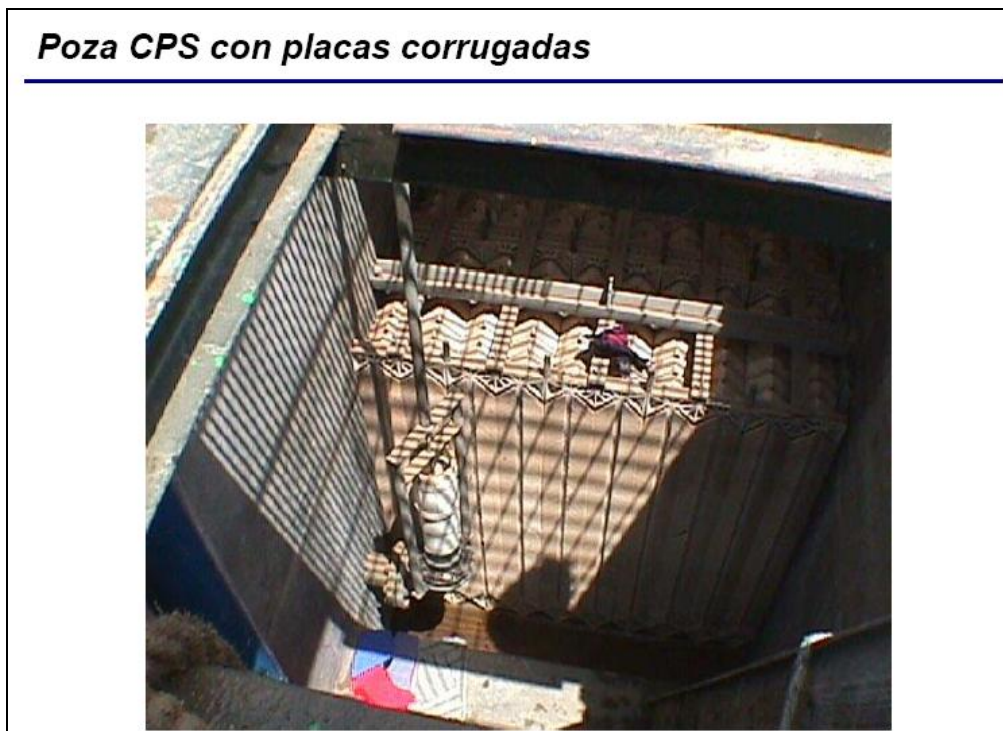
Figura 2. 11. Separador CPS de la planta de tratamiento de aguas aceitosas.
