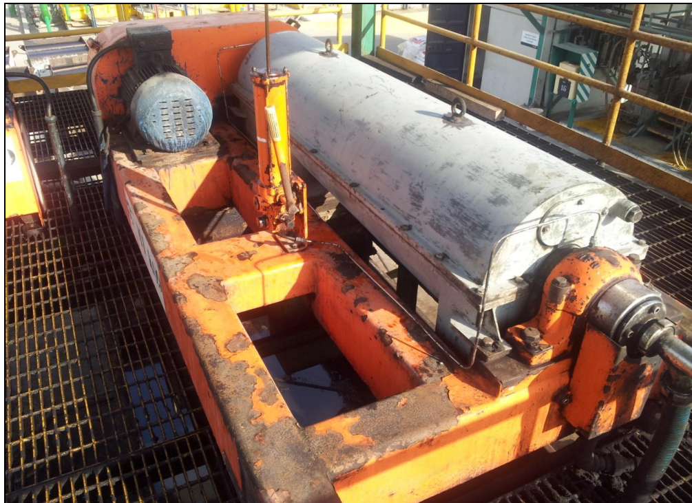
Figura 2. 20. Decantador centrífugo de la planta de tratamiento de aguas aceitosas.
