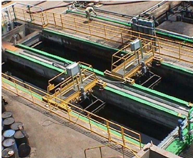
Figura 2. 7. Separador API de la planta de tratamiento de aguas aceitosas.
