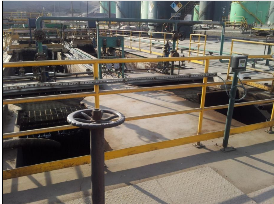
Figura 2. 21. API sur y norte de la planta de tratamiento de aguas aceitosas.
