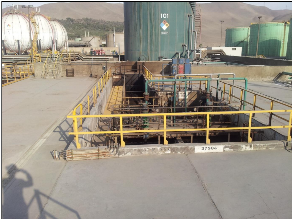
Figura 2. 9. Separador CPI de la planta de tratamiento de aguas aceitosas.
