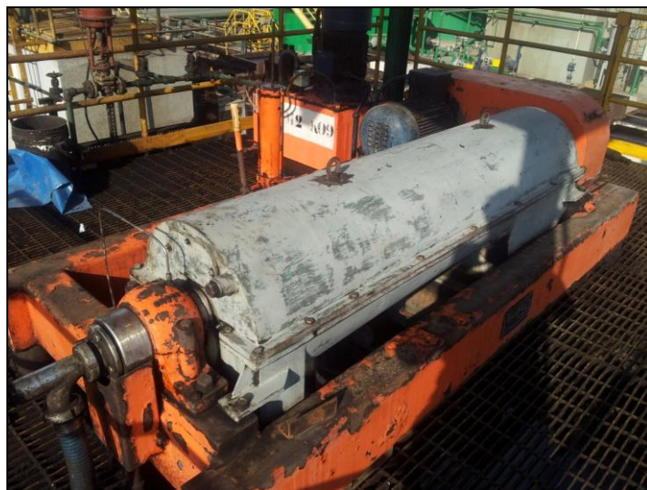
Figura 2. 38. Centrífuga de tornillo de la planta de tratamiento de efluentes residuales.
