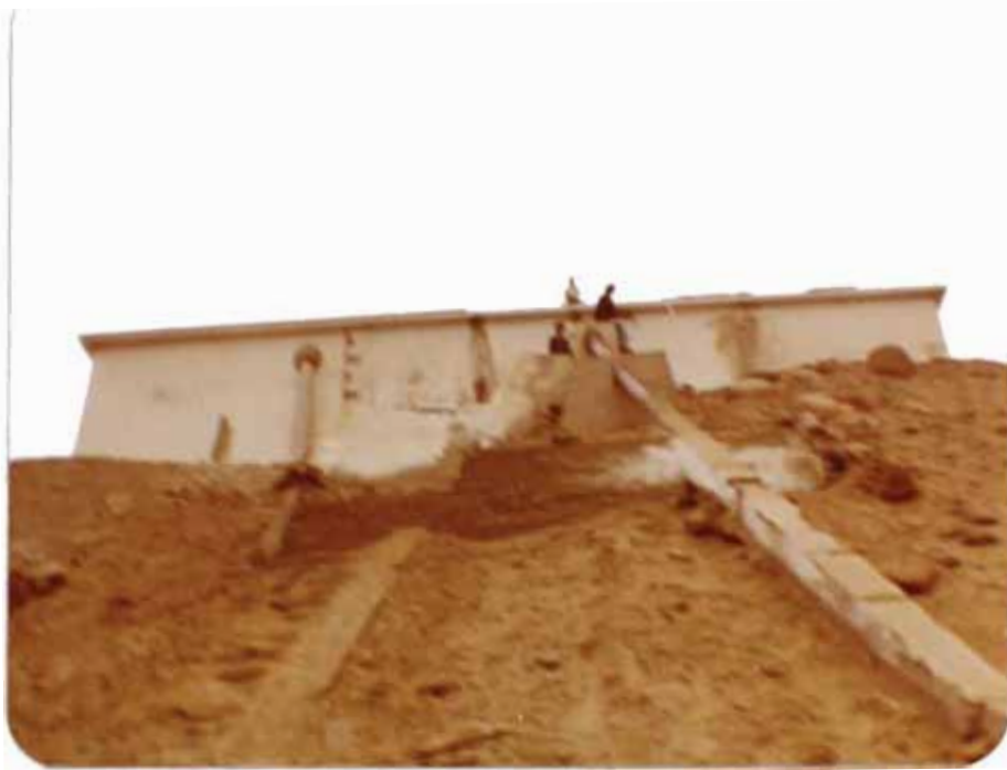
TANQUE DE REGULACION CON CAPACIDAD PARA 800 M 3 . NO SE LE USA ACTUALMENTE PUES PRESENTA FILTRACIONES. SE ENCUENTRA SOBRE EL CERRO CANDELA
