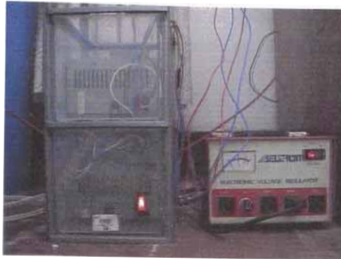
Figura 44: Fuentes de Alimentación y Estabilizador del Sistema
