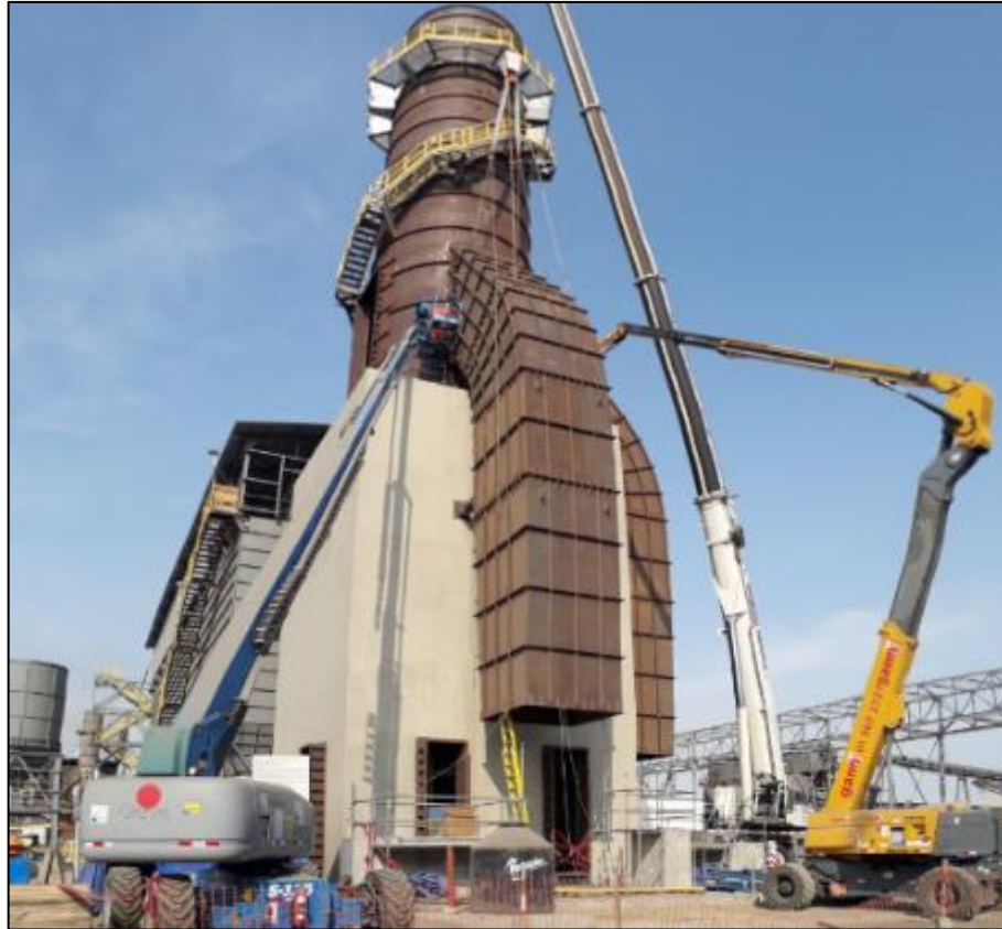
Figura N°92: Chimenea y ventiladores del FTP. Fecha: 27/02/2020. Fuente: Elaboración propia.
