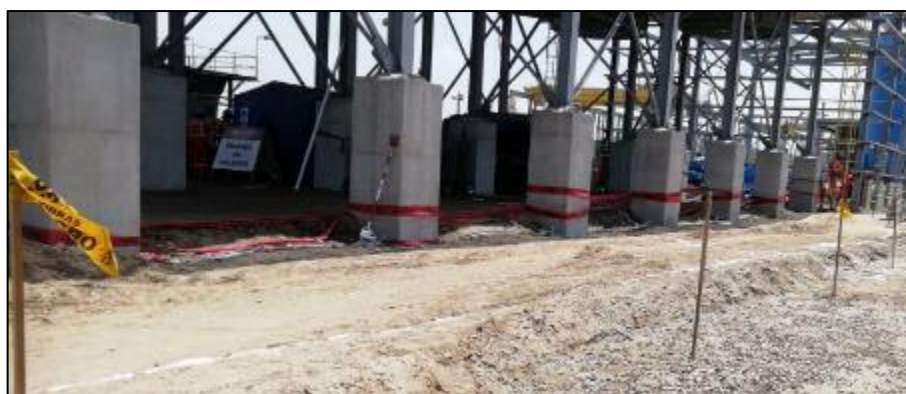
Figura N°101: Aerorefrigeradores del WTP. Fecha: 13/02/2020.
