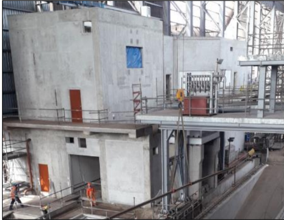
Figura N°74 Edificio eléctrico LF. Fecha: 04/02/2020. Fuente: Elaboración propia.
