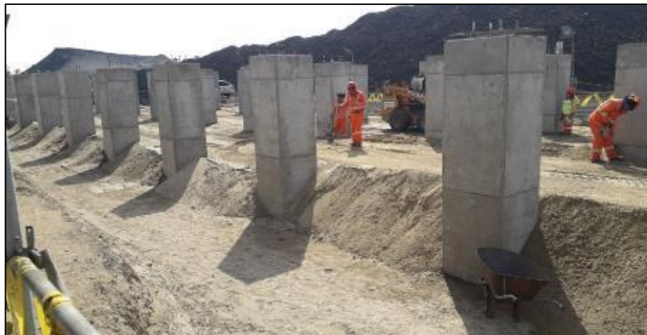
Figura N°100: Aerorefrigeradores del WTP. Fecha: 23/09/2019.
