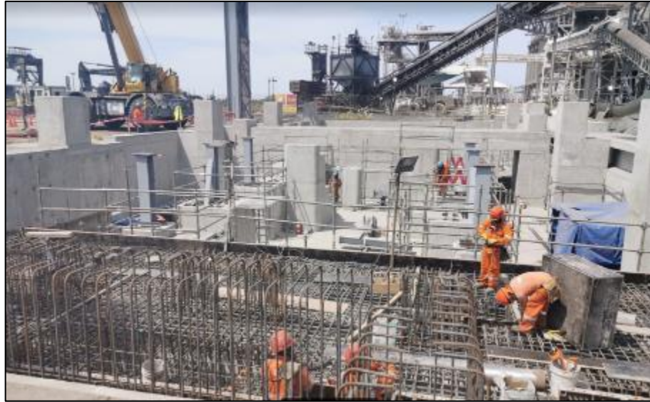
Figura N°79: CCM área 3 y 4. Fecha: 24/11/2019.
