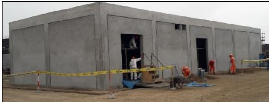
Figura N°93: Edificio eléctrico del FTP. Fecha: 04/06/2019. Fuente: Elaboración propia.
