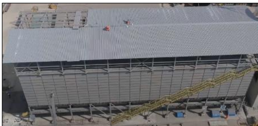
Figura N°91: Filtro de cartuchos del FTP. Fecha: 14/02/2020.
