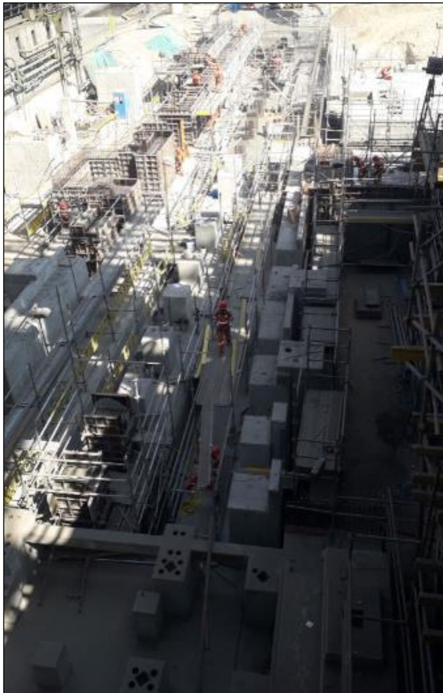
Figura N°78: CCM área 1 y área 2. Fecha: 15/10/2019.
