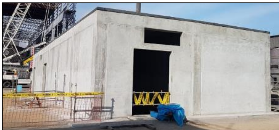
Figura N°94: Edificio eléctrico del FTP. Fecha: 06/09/2019.
