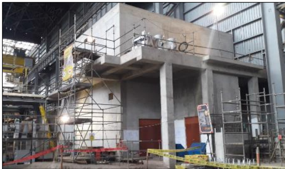
Figura N°75: Edificio eléctrico LF. Fecha: 21/02/2020. Fuente: Elaboración propia.
