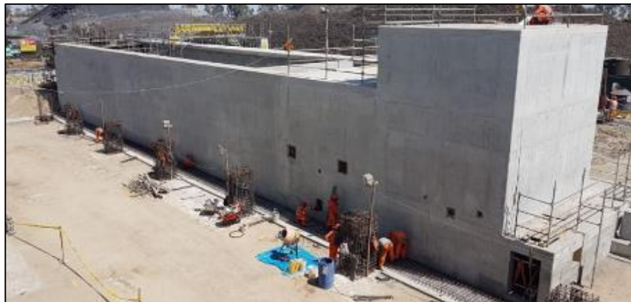
Figura N°97: Decantador del WTP. Fecha: 08/09/2019.
