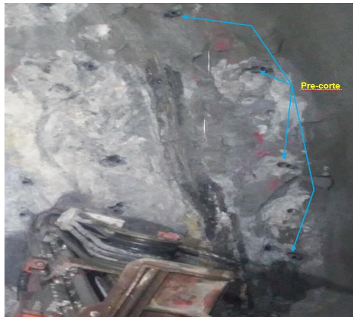
Figura 4,3 Deficiente perforación en pre-corte Fuente: Mina-estudio
