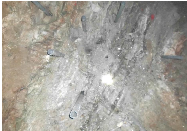
Figura 4,1 Inadecuado avance en Veta Elva Fuente: Mina-estudio
