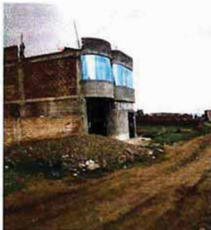
Foto 4.11 Vivienda típica de albañilería confinada de dos pisos en el ámbito de estudio. Fuente: Del autor
