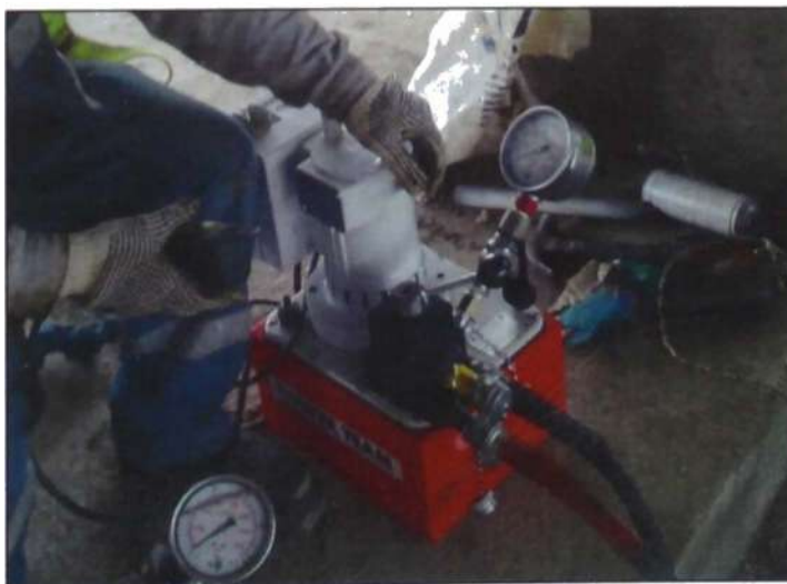
Figura N° 2.14.- Bomba Hidráulica Fuente: Samayca Ingenieros SAC – Obra Ampliación Clínica San Felipe
