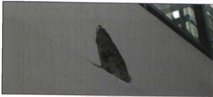
Figura N° 4.48.- Desprendimiento del concreto debido a la ruptura de un cable postensado. Fuente: Samayca Ingenieros SAC – Obra Reparación Estacionamiento Jockey Plaza – Local de Papachos
