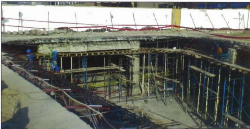
Figura N° 4.43.- Colocación de anclajes móviles en la Losa Postensada (Ducto Trapezoidal) Fuente: Samayca Ingenieros SAC – Obra Reforzamiento Estacionamiento Jockey Plaza
