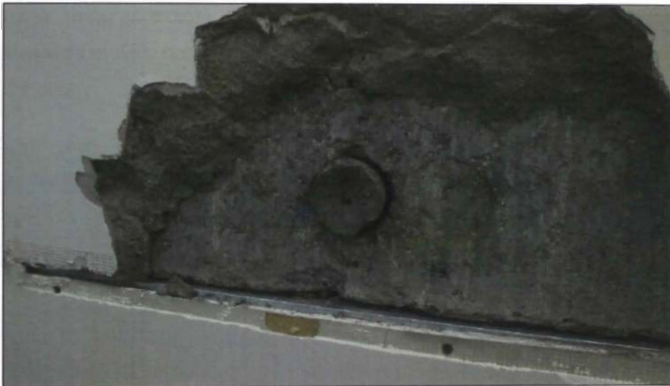
Figura N° 4.47.- Desprendimiento del concreto debido a la ruptura de un Cable Postensado. Fuente: Samayca Ingenieros SAC – Obra Reparación Estacionamiento Jockey Plaza – Local de Papachos
