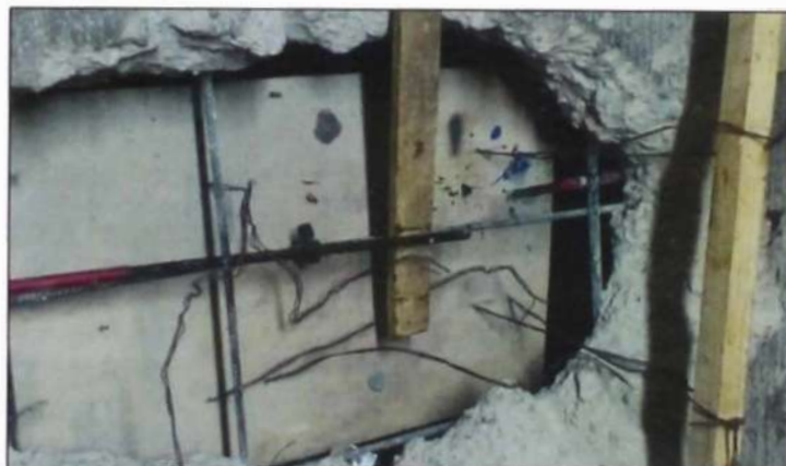
Figura N° 4.49.- Picado de zona donde el cable ha sido afectado.
