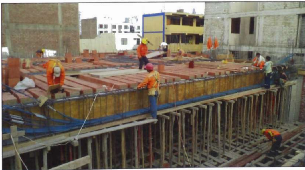
Figura N° 4.8.- Instalación de Vigas Postensadas Fuente: Samayca Ingenieros SAC – Obra Colegio de Ingenieros Trujillo
