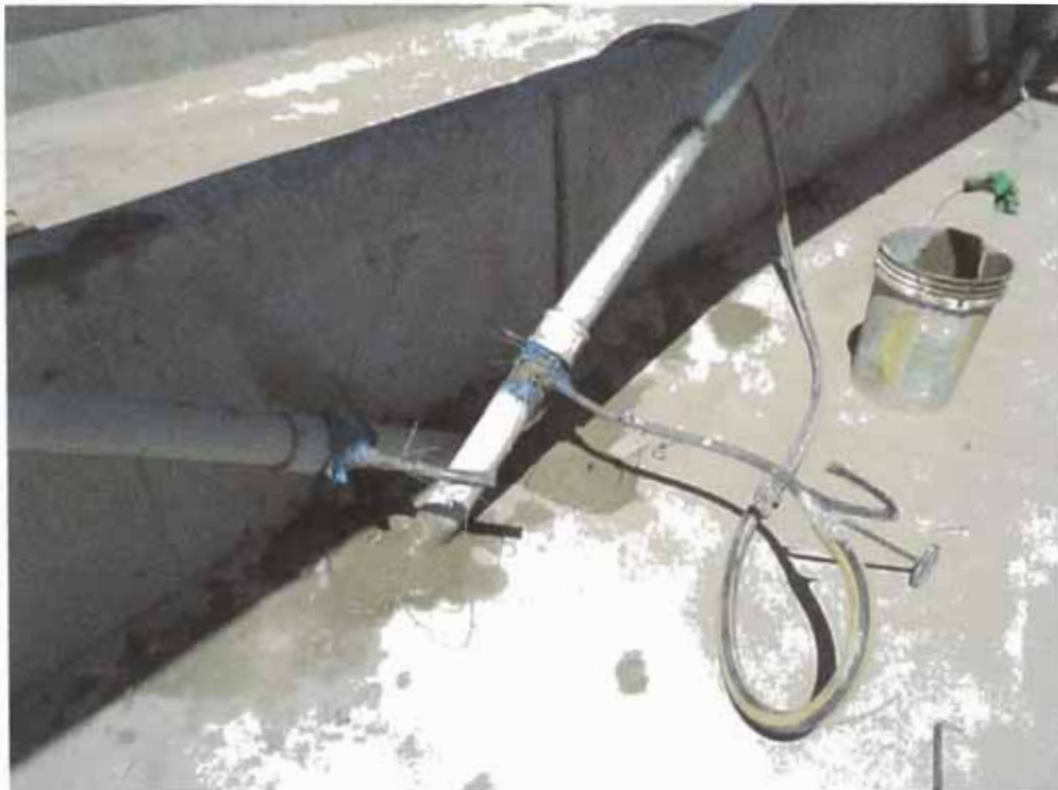
Figura 18. Inyección de Grout dentro de los tubos de polietileno de las barras.
