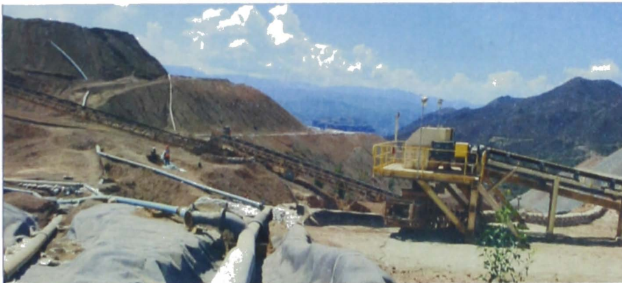
Figura 1.13: Disposición de mineral chancado a un tamaño máximo de 3/8", con fajas transportadoras en una pila de lixiviación de oro, ubicado en México.
