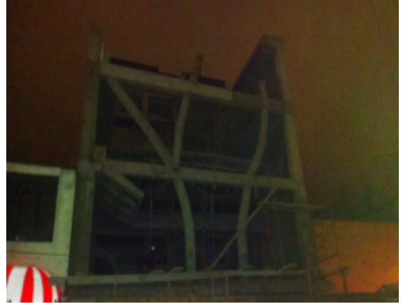
(b) Columnas deformadas
