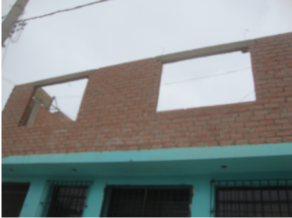
(a) Dintel vulnerable a caída
