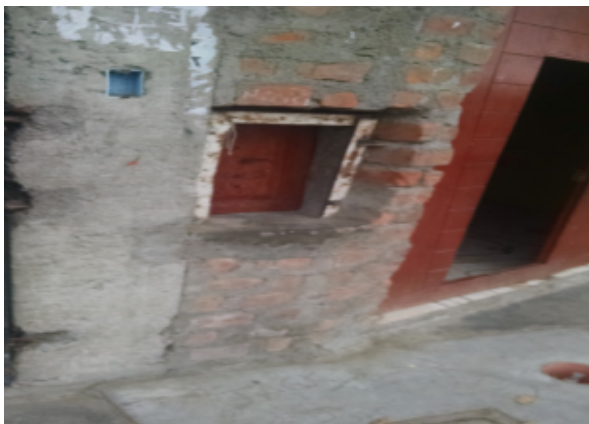
(c) Vano en muro incorrecto
