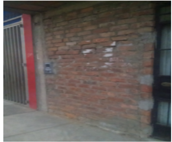
(f) Incorrecto asentado de las unidades de albañilería
