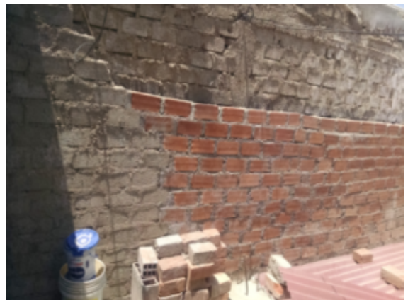
(d) incorrecto alineamiento, cambio de material y falta de elemento confinante
