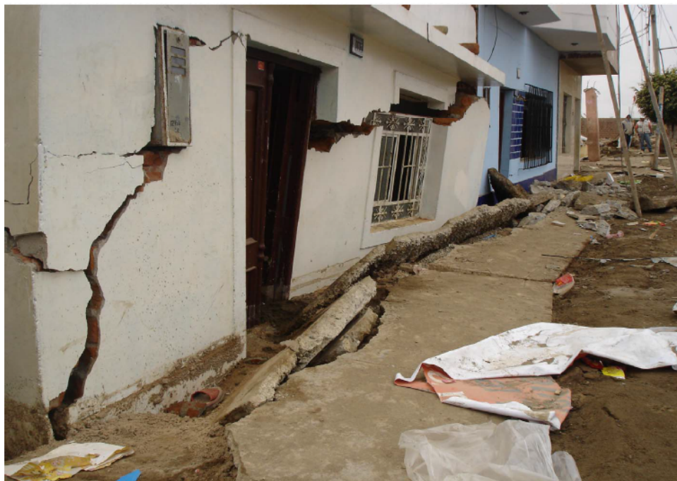
Sismo de Ica 8.0 Kw, se visualiza que la albañilería sin confinar presenta un pésimo comportamiento en comparación con la albañilería confinada.
