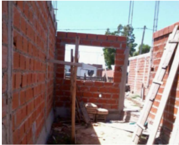
(e) Se está empleando unidades de albañilería como dintel
