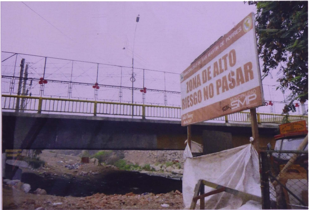
Fotografía 3: Vista de la zona bajo el puente Dueñas, conocida por representar un peligro social. Por el lado ambiental, es zona de desmonte y residuos sólidos – 23/07/2020.
