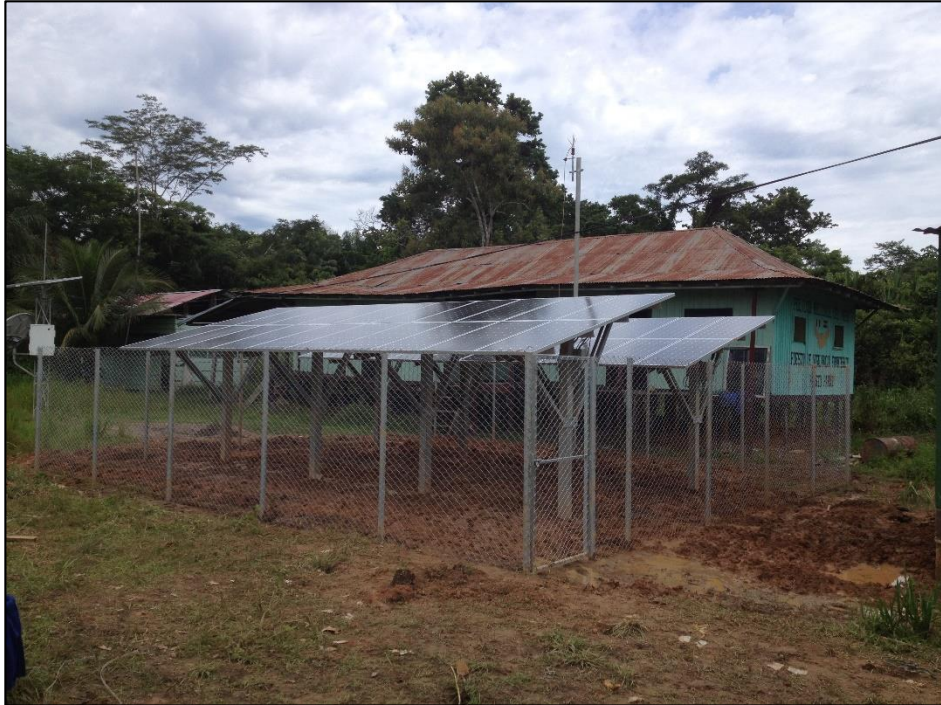
Figura 3.8. Arreglo fotovoltaico y estructuras inslados. (Fuente: Norte Renovables).
