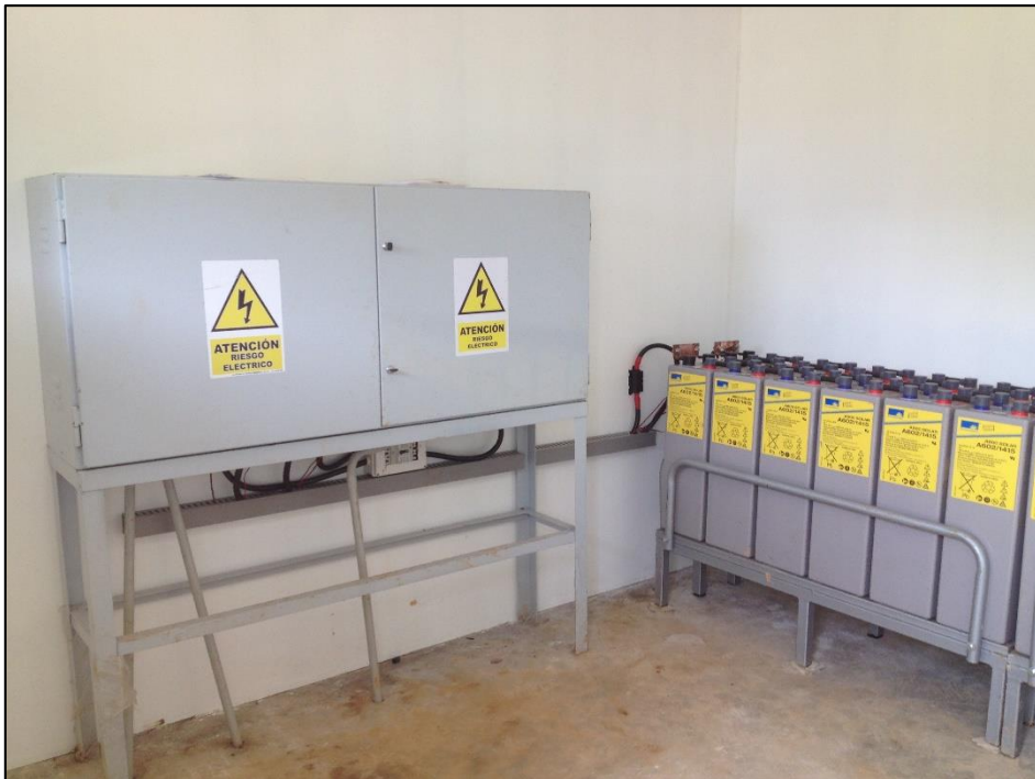
Figura 3.9. Banco de baterías y tablero de control y potencia. (Fuente: Norte Renovables).
