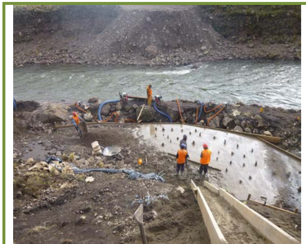
Puente Carrozable en el rio Palca del sector Ruelas, vaceado del estribo Fecha 20//12/2012
