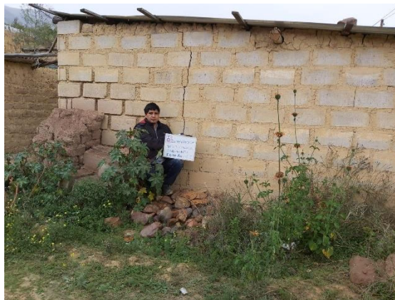
Figura 3.2. Grieta en vivienda de paredes de bloques de cemento y arcilla
