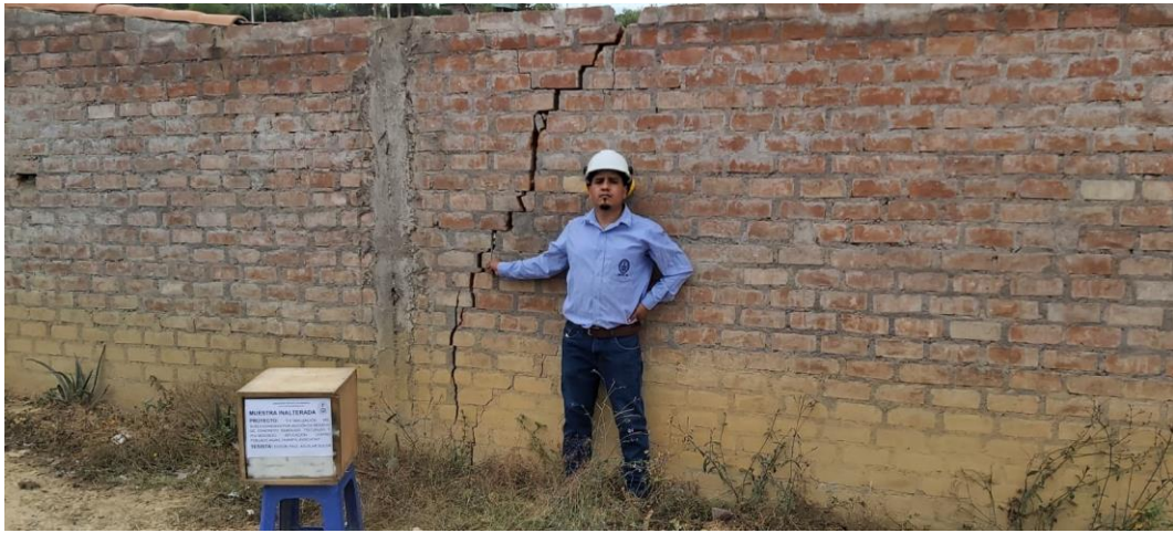
Figura 3.1. Grieta en pared de ladrillo con columnas de amarre de concreto
