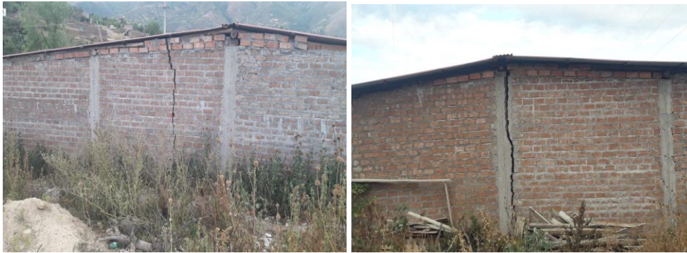
Figura 3.3. Grieta en vivienda con paredes de ladrillo confinada lateralmente con columna de concreto
