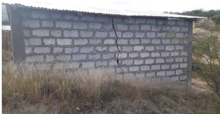
Figura 3.4. Grieta en vivienda con paredes de bloques de cemento confinada mediante columnas de concreto
