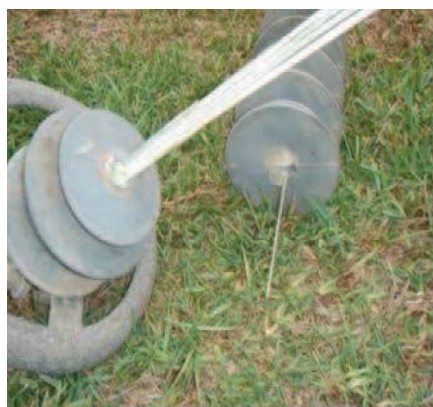
Fig. 2.6 Línea 220 kV Huancavelica-Independencia L-2203 T-486, aislador se rompió después de 11 años. Fuente: (Loardo & Energía, 2010)
