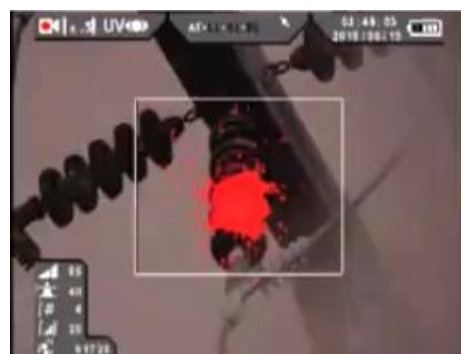
Fig. 2.10 Manifestación de descargas corona en S.E. 60kV Villa el Salvador Fuente: (Loardo & Energía, 2010)
