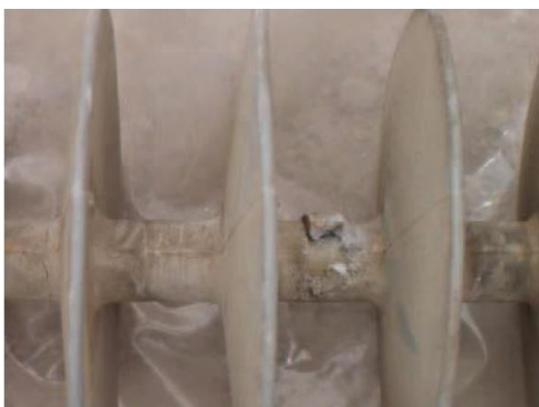
Fig. 2.7 Línea 220 kV Pomacocha-San Juan L-2205 T-555. Aislador con núcleo expuesto. Fuente: (Loardo & Energía, 2010)
