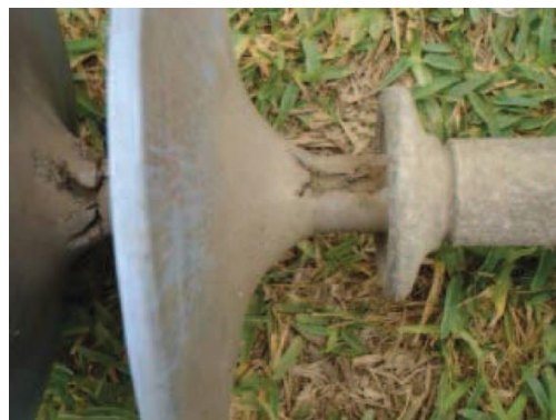
Fig. 2.8 Línea 220 kV Chilca- Desierto L-2208 T-131. Aislador erosionado (heavy digging). Fuente: (Loardo & Energía, 2010)
