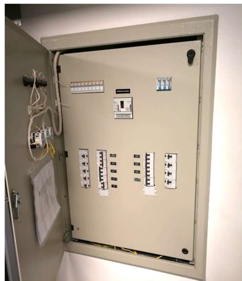
Imagen N° 29 Tablero eléctrico de distribución
