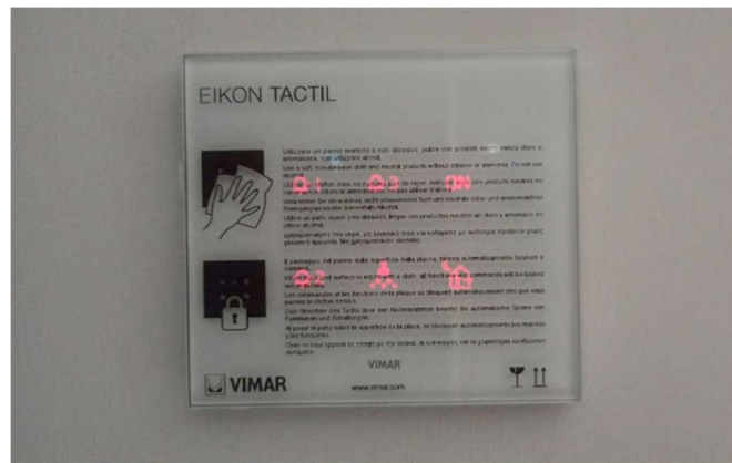
Imagen N° 37 Mando táctil instalada en pared (Fuente: Empresa Giadan Inversiones SAC)
