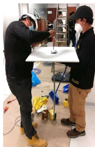
Imagen N° 35 Transmisor EnOcean, cableado –inalámbrico (Fuente: Empresa Giadan Inversiones SAC)
