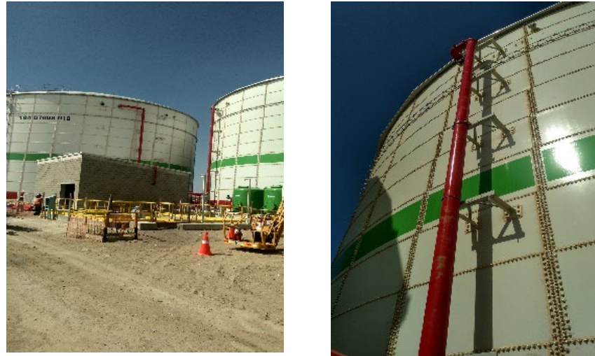
Figura 19 Casa de bombas y Tuberías SPCI
