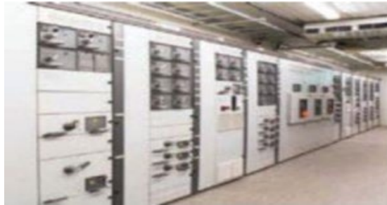
Figura 6 Centro de control de motores
