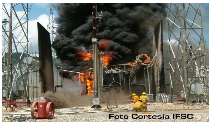
Figura 2 Transformador incendio, no funcionó el SPCI
