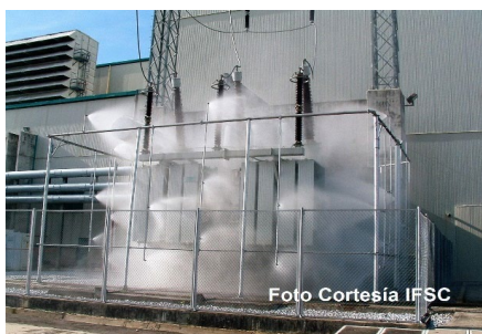
Figura 3 Transformador con sistema de aspersión, pared corta fuego y foso con piedras
