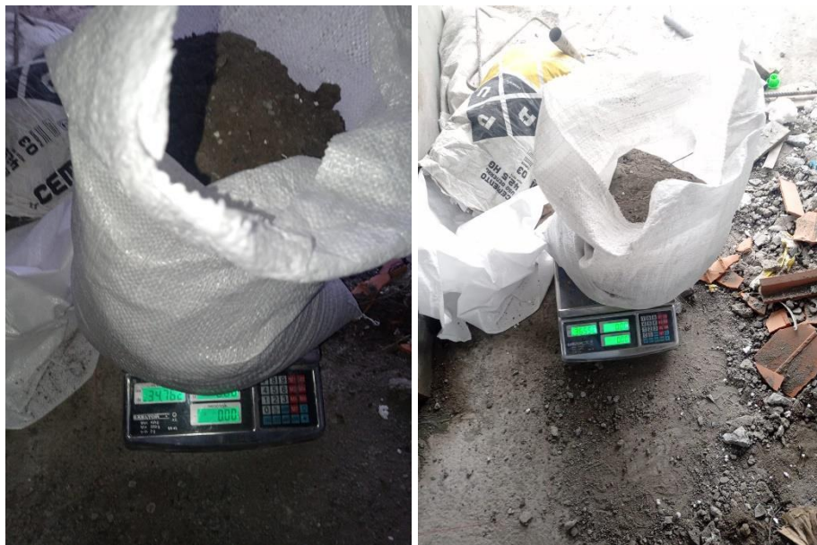
Figura N°28. Pesaje de los sacos con escombros de concreto y residuos de mortero
