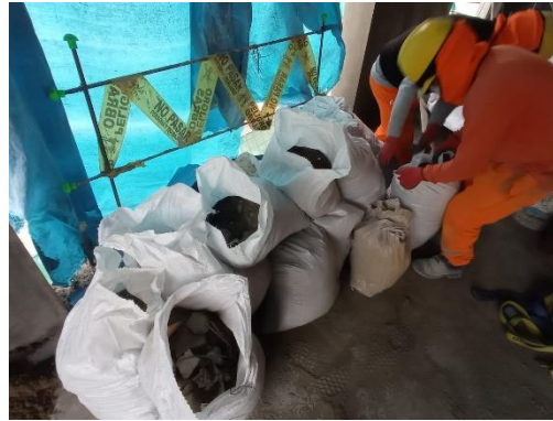
Figura N°27. Punto de acopio para los sacos con escombros y residuos de mortero
