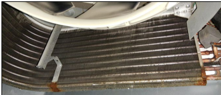
Figura 2.44. Serpentin saturado por suciedad Fuente: Archivo propio
