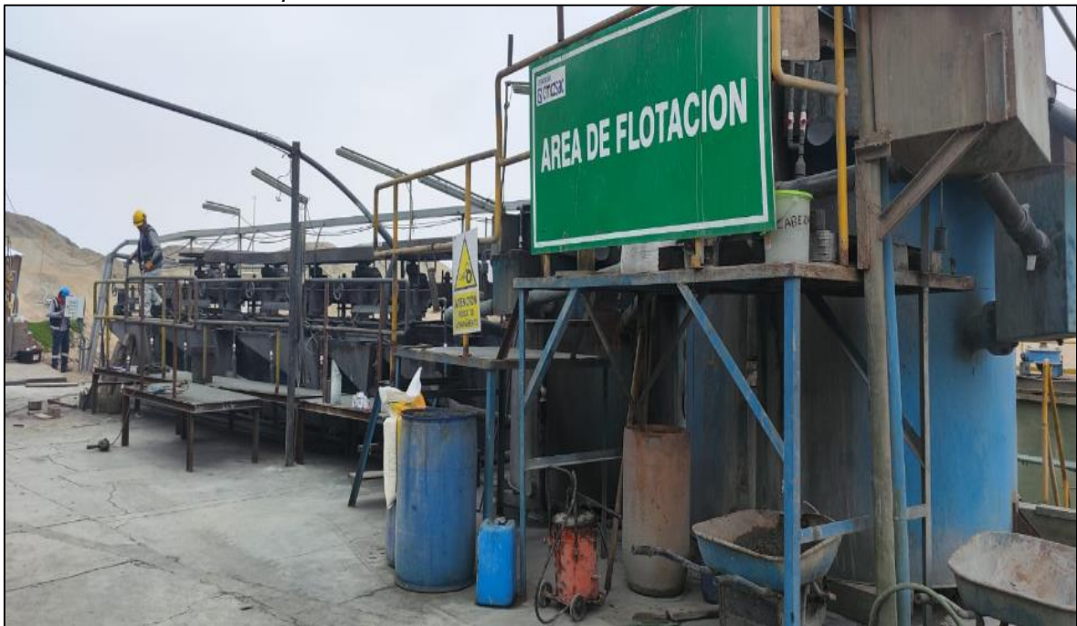
Circuito de flotación de plomo.
