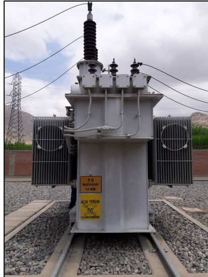
Figura 5.6 Transformador de la SET Andahuasi.
