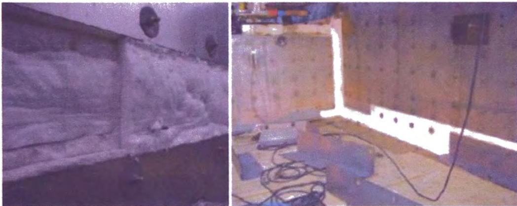
Figura 20. Instalación de aislamiento faltante entre paneles y en las esquinas
