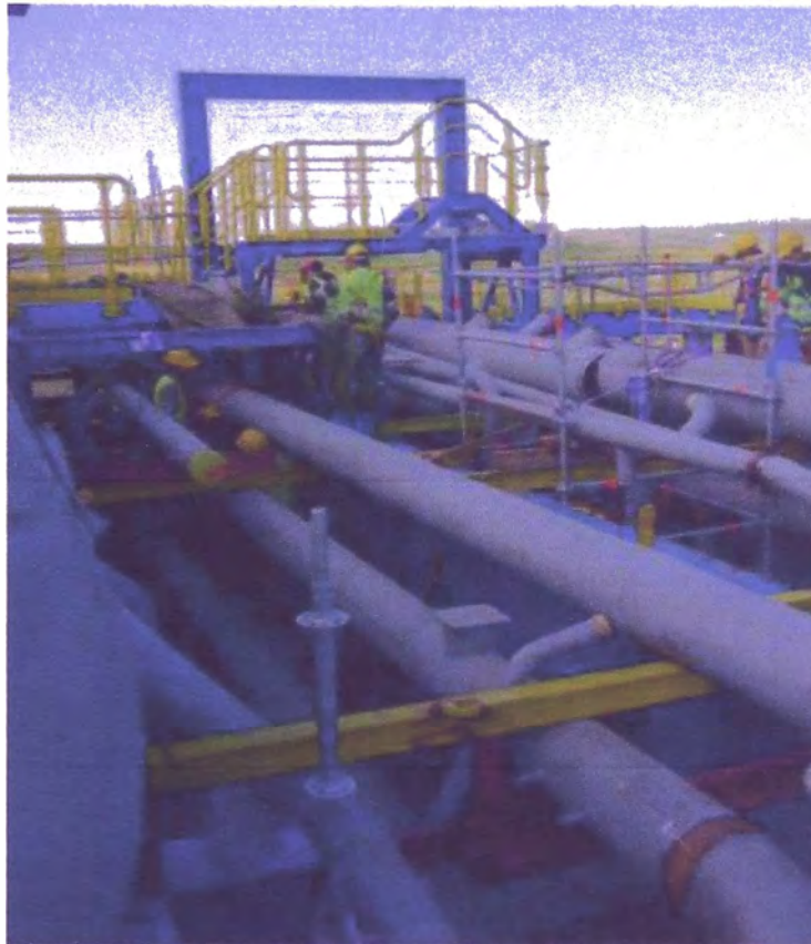
Figura 54. Conexión de las tuberías de la parte superior de la calera.
