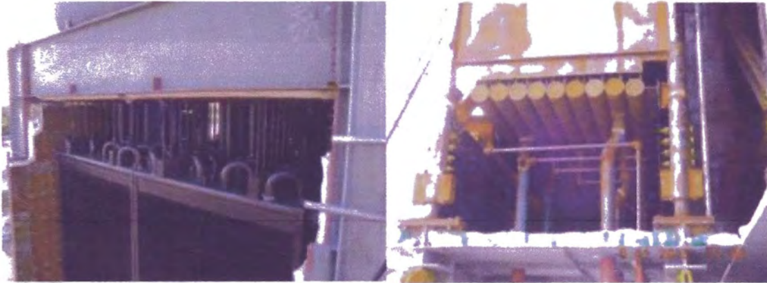
Figura 45. Conexiones internas superior e inferior de tubería entre módulos.
