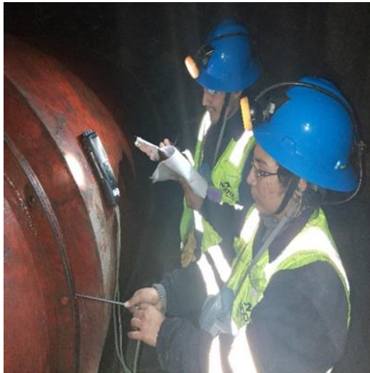
Figura 4: Medición de presiones en el ventilador Airtec de 60 KCFM en el aforo de ingreso de aire – TJ02W
