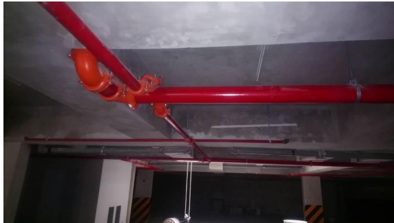
Figura 13: Sistema de Agua contra incendios finalizado.
