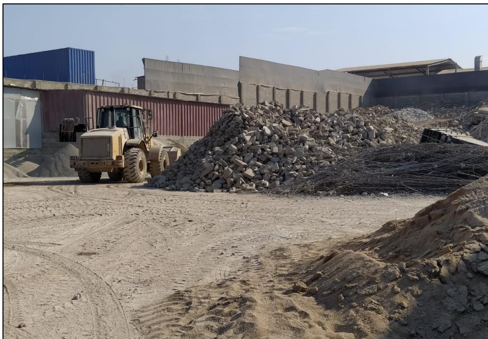
Figura 1 Planta de producción del agregado reciclado.
