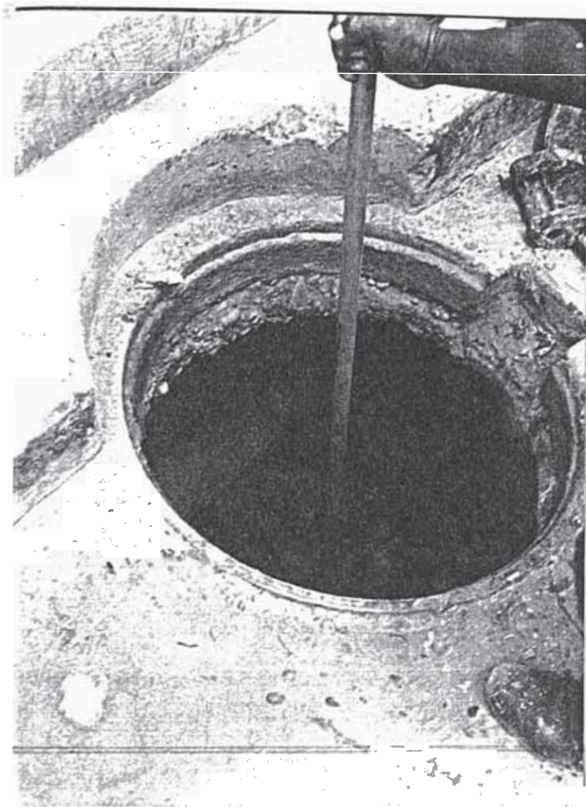
Foto 8.6.- Instalación Sanitaria no higiénica, nótese que la tubería de agua pasa por el buzón de desagüe
