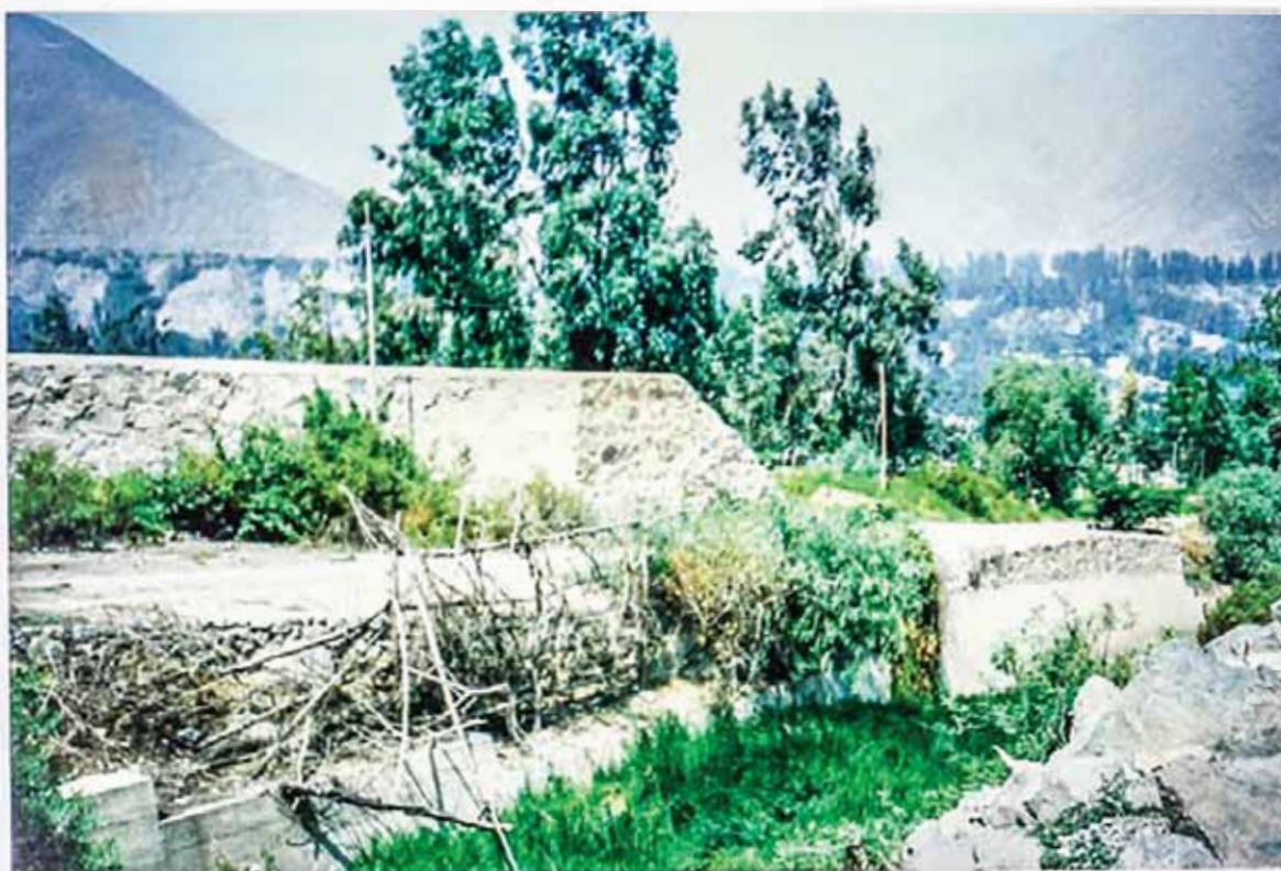
Foto N°12.- Vista del muro de piedras construido por Electrolima, tomada en dirección del flujo del agua, a la derecha del canal se encuentra la saliente del cerro (no se ve). La zona es crítica debido a este estrangulamiento, por lo que es necesario cortar dicha saliente, para permitir que el canal de sección compuesta continúe su recorrido hacia el cauce bajo.
