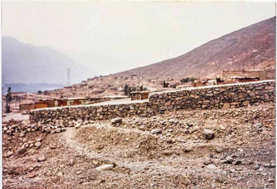
Foto N°5.- Vista de la parte final del muro de piedras construido por el PAIT, con la finalidad de proteger las viviendas que se encuentran en la margen derecha pero fue construido sin una buena cimentación y orienta al flujo aluvional hacia el montículo de las ruinas de Yanacoto, lo cual podría provocar un vórtice. Este muro tiene que ser nuevamente construido, pero tomando en cuenta todas las precauciones para que resista la presión del huayco.
