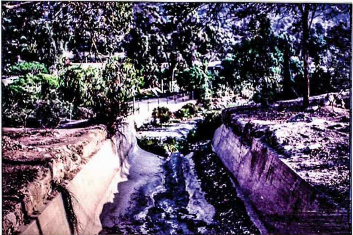
Foto N°23.- Deseembocadura del canal de desasias de la antigua Central Hidroeléctrica de Yanacoto al río Rimac, vista desde la carretera Central. Se observa que dentro del canal la vegetación es mínima, existe acumulación de basura y la erosión de fondo es notoria. Este tramo requiere limpieza y adecuación.
