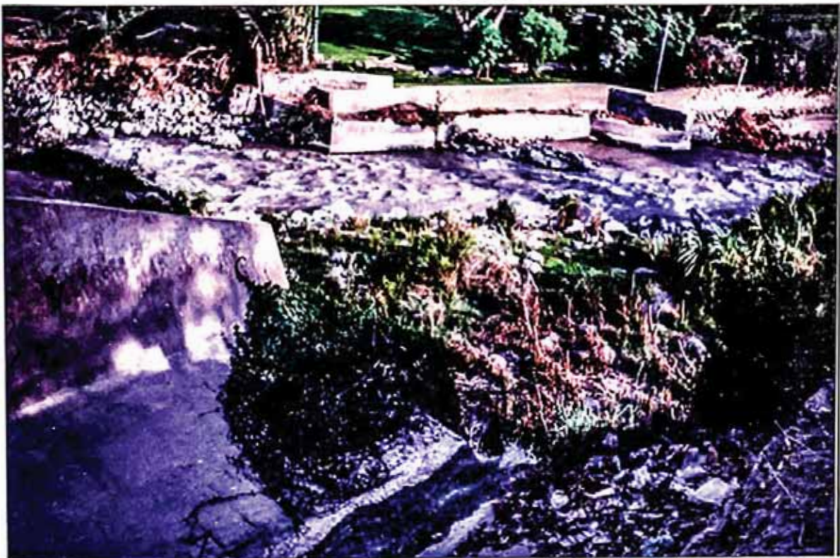
Foto N°24.- Deseembocadura del canal de desasias de la antigua Central Hidroeléctrica de Yanacoto al río Rimac, zona en la que se han formado escarpas que varían de 15 a 20 m. de altura, los pequeños aportes de este canal al río han hecho que se forme un meandro que desvía al río hacia su margen izquierda.
