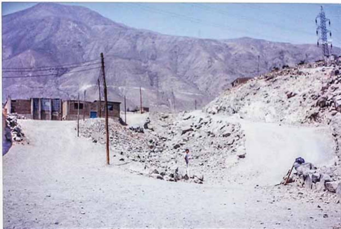
Foto N°7.- Vista del tramo final del cauce medio natural, el cual al llegar al camino con asistencia de badén, pierde sus dimensiones de ancho y profundidad. Las viviendas se encuentran demasiado cerca, por lo que se verán afectadas con la construcción de la rápida. Esta zona sería el tramo final de dicha obra, la cual tendría que empalmar mediante una transición con el canal de desasias de la antigua C. H. de Yanacoto y otro canal ligado a este con el fin de mantener la sección de descarga.
