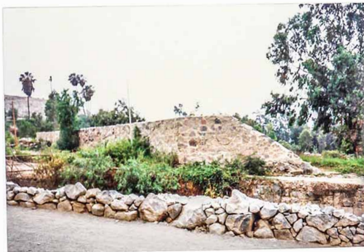
Foto N°14.- Vista del muro de rocas construido por Electrolima, tomada desde la saliente del cerro, el canal de demasías se encuentra en medio de estos.
