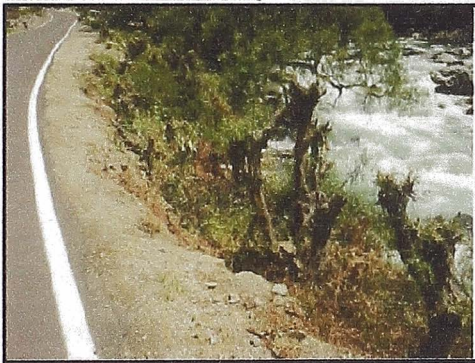
FOTO N° 2: GEOMETRÍA DE LA VÍA, calzada angosta.
