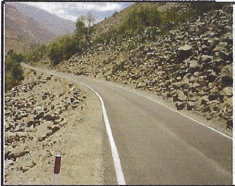
FOTO N° 1: DESLIZAMIENTOS, riesgo de derrumbes por inestabilidad de taludes
