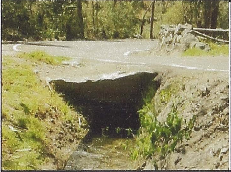
FOTO N° 1: DERRUMBE, inestabilidad de la plataforma por paso de canal transversal.
