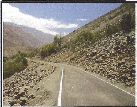
FOTO N° 2: DESLIZAMIENTOS, riesgo de derrumbes por inestabilidad de taludes
