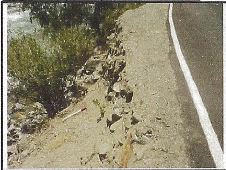
FOTO N° 1: EROSIÓN. la plataforma se puede afectar debido a la acción del río.
