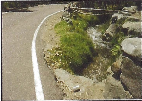
FOTO N° 3: DESLIZAMIENTO, inestabilidad de la plataforma por filtraciones de aguas de canal.
