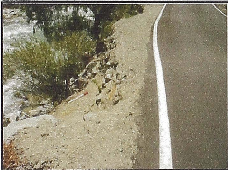
FOTO N° 2: GEOMETRÍA DE LA VÍA. calzada angosta.
