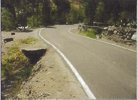
FOTO N° 2: GEOMETRÍA DE LA VÍA, calzada angosta, sin señalización por canal.
