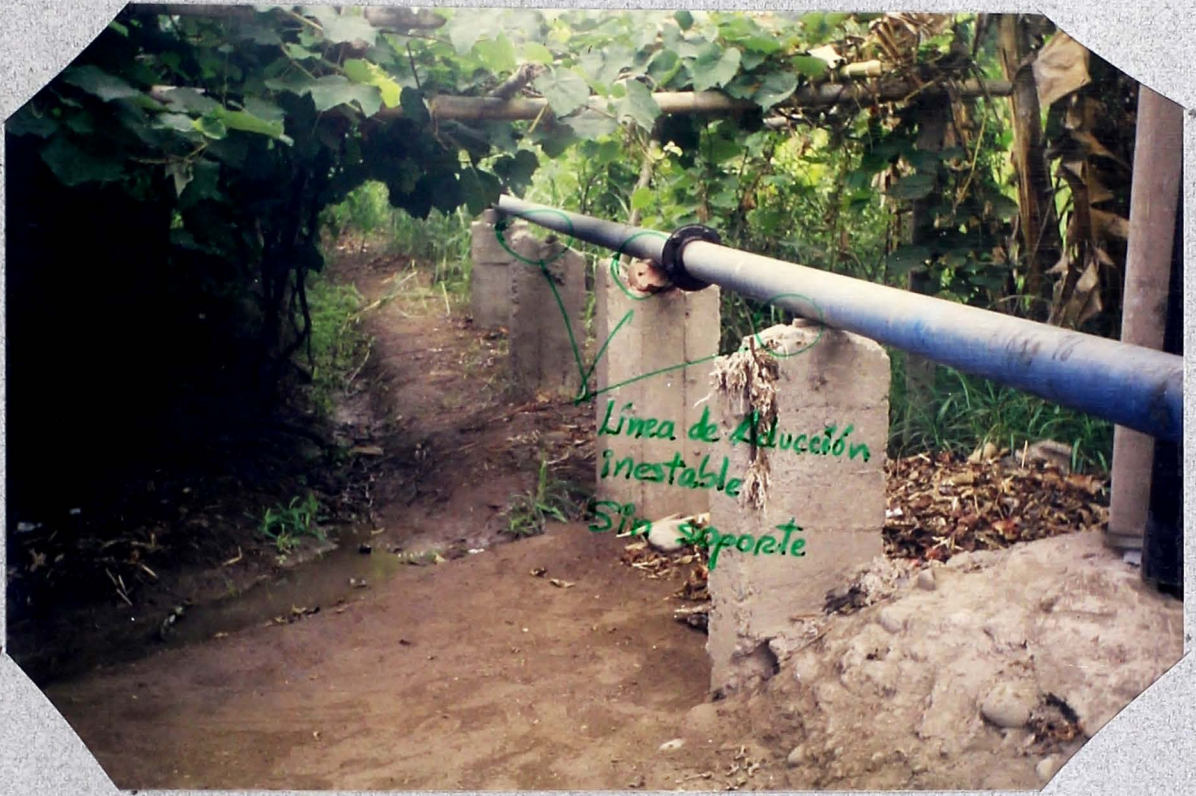
FOTO N° 29 LÍNEA DE ADUCCIÓN VULNERABLE A COLAPSO
