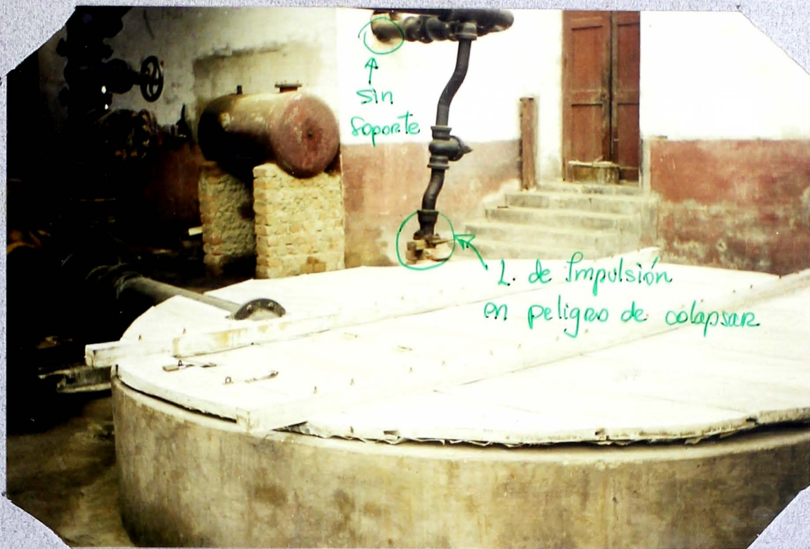
FOTO N° 3 ESTACION DE BOMBEO N° 3
