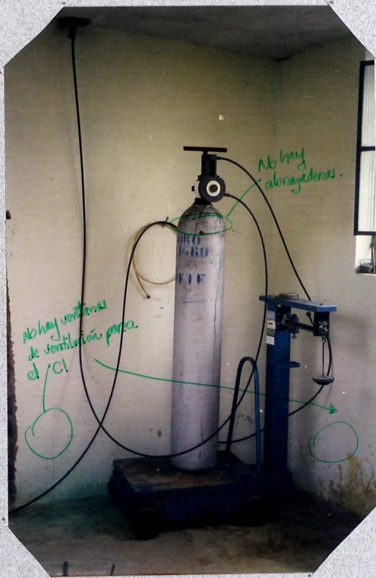
FOTO N° 9 CILINDRO DE CL NO SUIETADO Y SIN VENTANA DE VENTILACIÓN - CASO : LUNAHUANÁ - SAN ANTONIO
