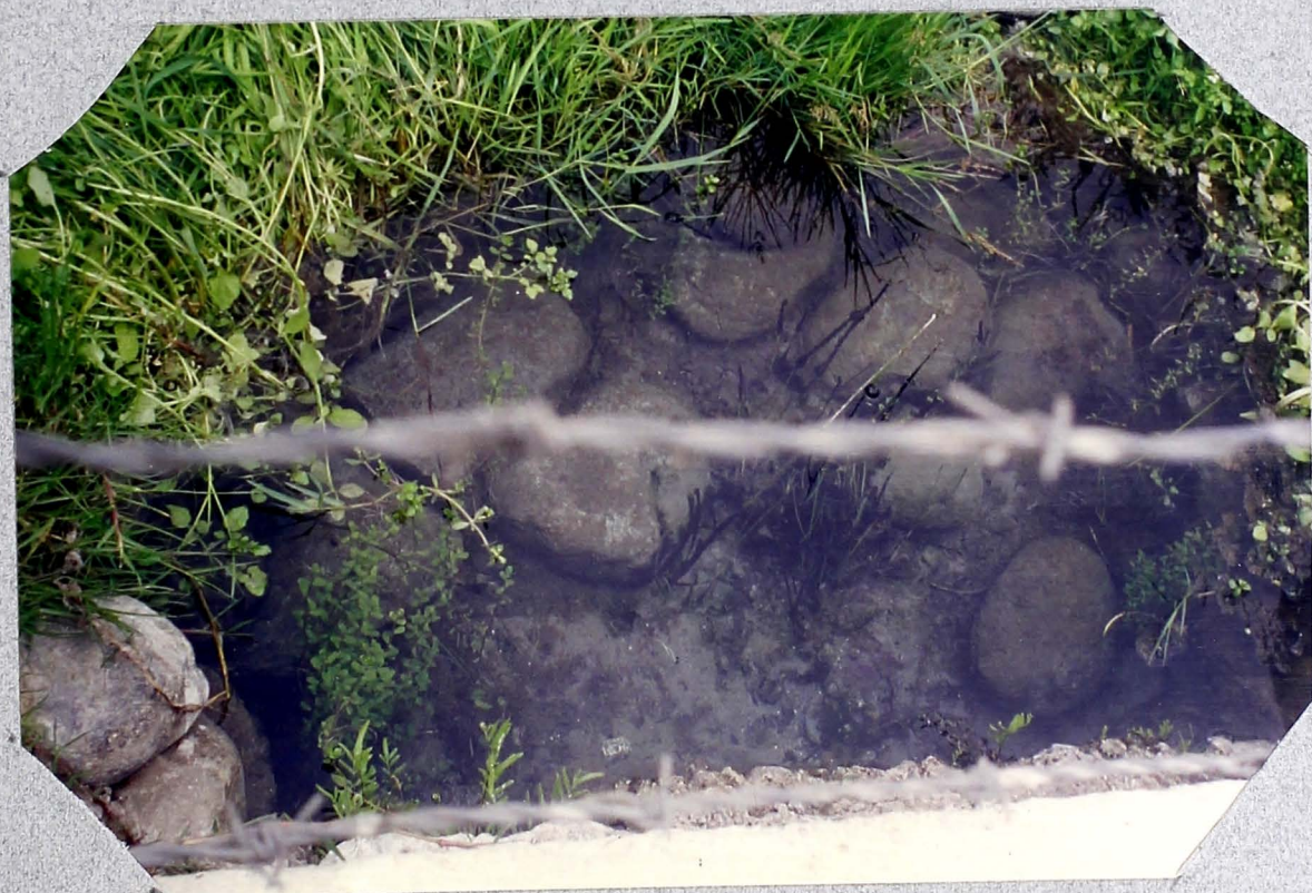
FOTO N o 8 ENTRADA A GALERIA FILTRANTE
