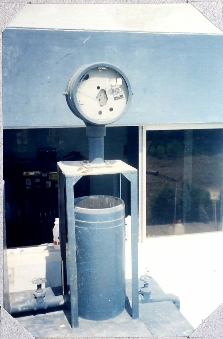
IMPERIAL FOTO N° 10 (Izg.) MACROMEDIDOR MALOBRADO PTA. N° 1
