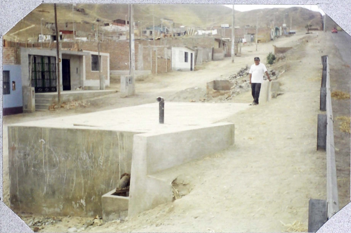
FOTO N° 24 CAMARA DE REBOMBEO "VILLA PARAISO" AL COSTADO DE ANTIGUA PANAMERICANA SUR.
