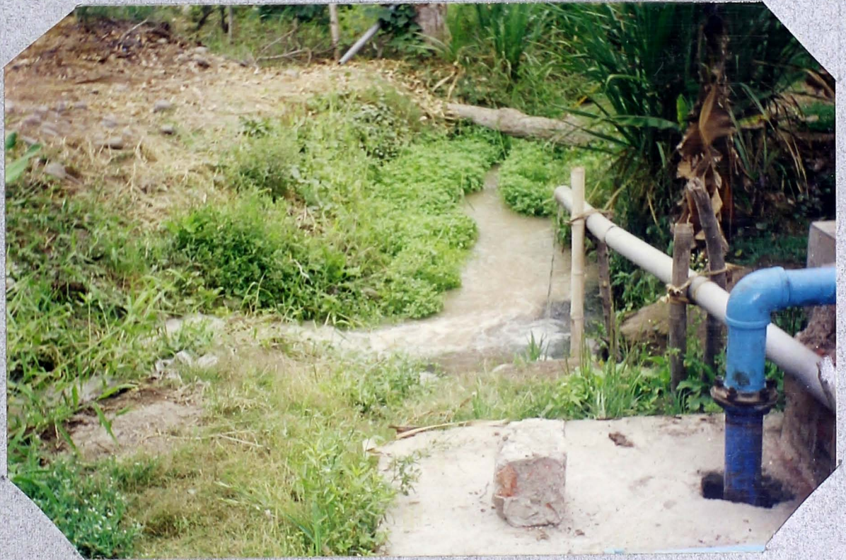
FOTO N° 28 TUBERÍA DE REBOSE A CANAL
