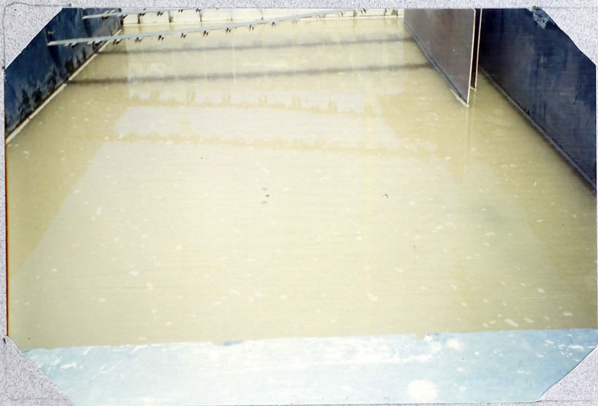
FOTO N°12 PTA. DE TRATAMIENTO N°2 FLOCULADOR SIN PANTALLAS EN 1 er COMPARTIMIENTO
