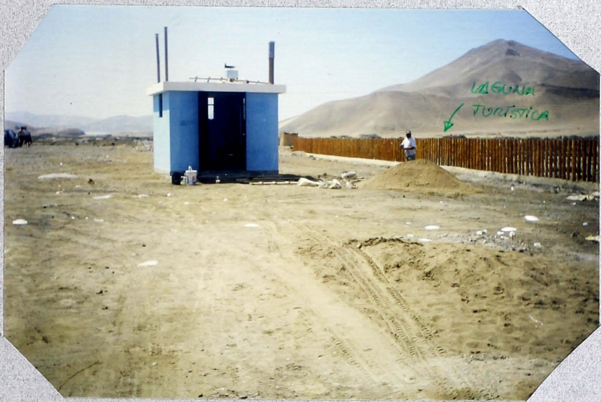
FOTO N° 32 ESTACIÓN TÍPICA DE BOMBEO DE DESAGÜE N° 3 - CERCA A LA LAGUNA LA MILAGROSA - ANEXO LAS SALINAS.
