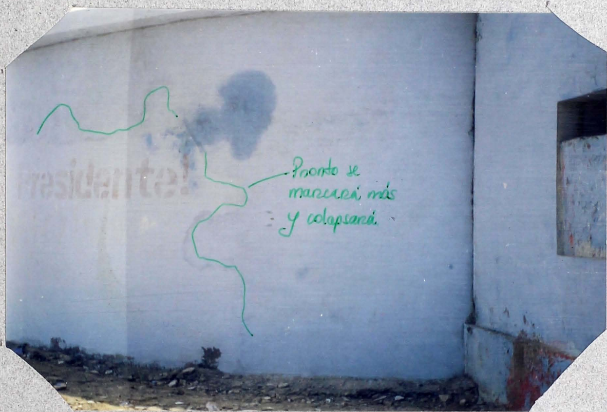
FOTO N° 15 - RESERVORIO - FILTRACIÓN DE AGUA EN CUBA
