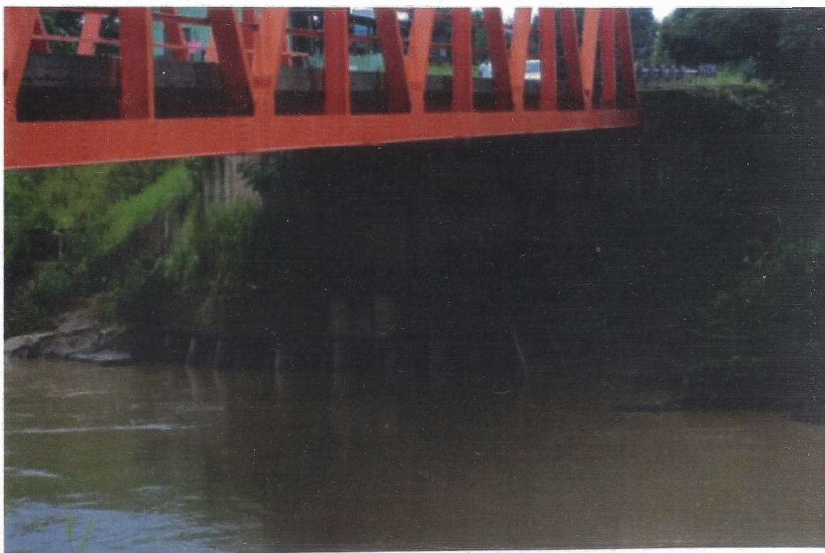
Foto N°06: Pilotes expuestos por el impacto del flujo al estribo derecho del puente Mavila.
