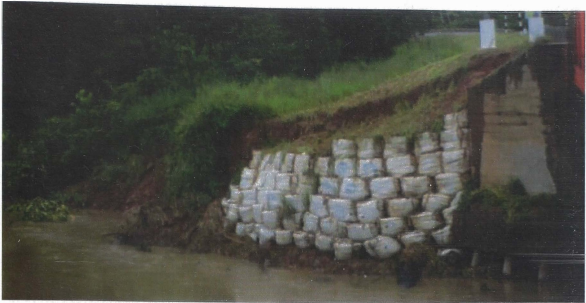
Foto N°03: Geobolsas al pie del terraplén de estribo izquierdo aguas arriba del puente Mavila. Además se muestran los pilotes expuestos por efectos del proceso de socavación.
