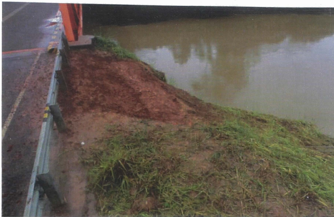
Foto N°05: Proceso de socavación que ataca el terraplén izquierdo de puente y la losa.
