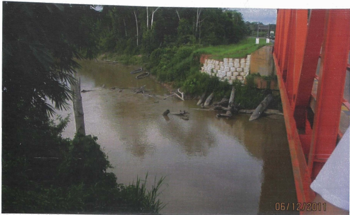
Foto N°03: Protección aguas arriba del estribo izquierdo del puente Mavila en el año 2011, vemos como está siendo atacada por los procesos de socavación y aumento de curvatura del río.
