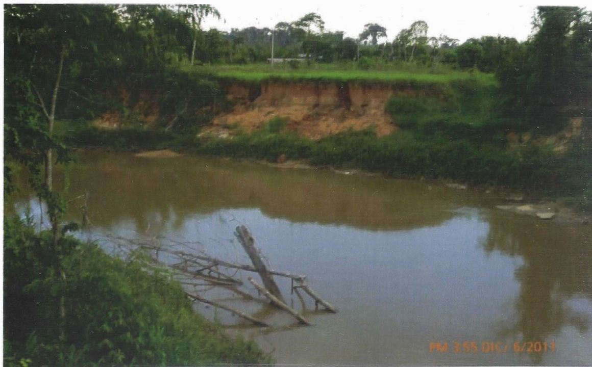
Foto N°06: Margen derecha del río Manuripe, aguas arriba de puente. Vemos como está siendo atacada por los procesos de erosión por el impacto del río.
