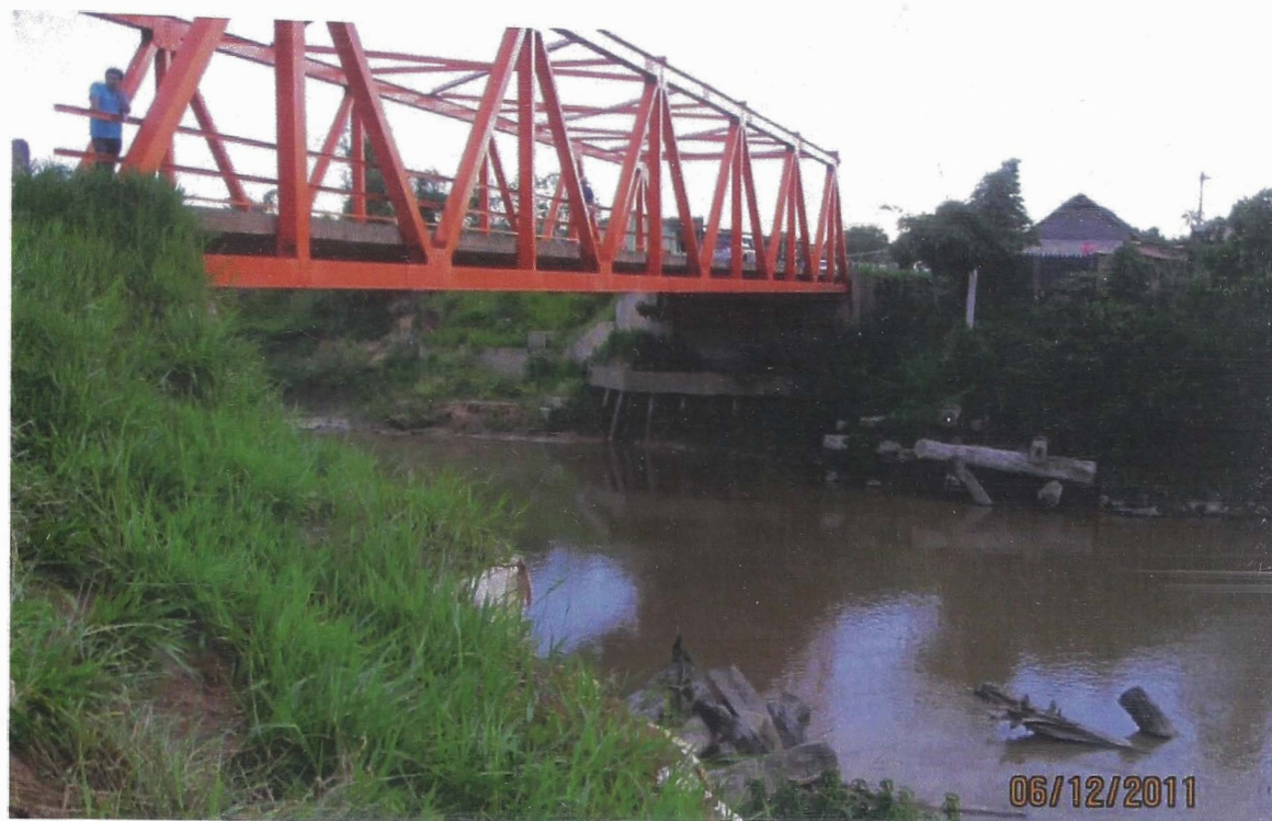
Foto N°05: Pilotes expuestos del estribo derecho del Puente Mavila. Vemos como el impacto directo del flujo daña la cimentación del puente.
