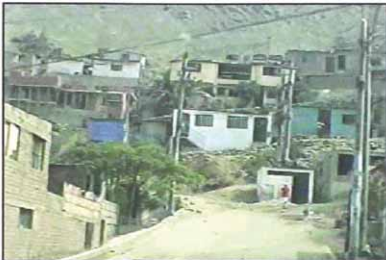
Foto N° 6.09. Sub estación debajo de un muro de pirca en condiciones precarias ubicado al ingreso del asentamiento humano "Jesús de Nazaret".
