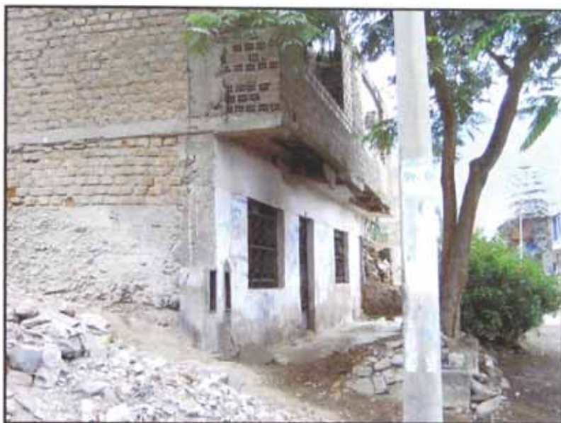
Foto N° 608. Vivienda ubicada en la Calle Manco III del P. J. "Leoncio Prado", el aligerado está ha fallado y en un movimiento sísmico fallaría causar pérdidas humanas
