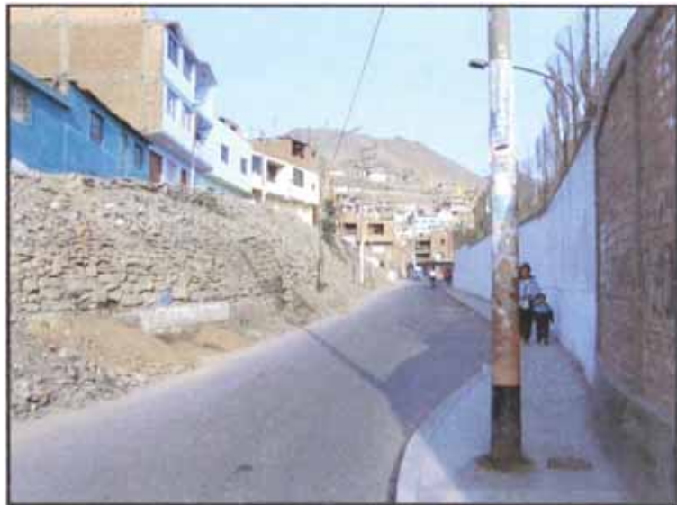
Foto N° 6.11. Talud que podría colapsar en un movimiento sísmico de considerable magnitud, provocando tráfico vehicular y peatonal. Av. Lealtad, A. H. "Villa El Ángel" zona de La Unificada.
