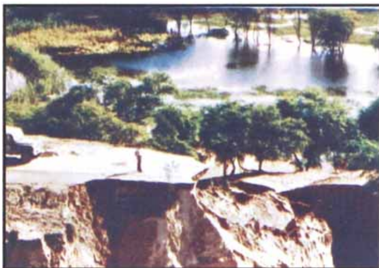
Foto N° 2.03. Se observa la erosión en la Carretera Piura-Paita, al norte de Perú. El Niño 1982-1983.
