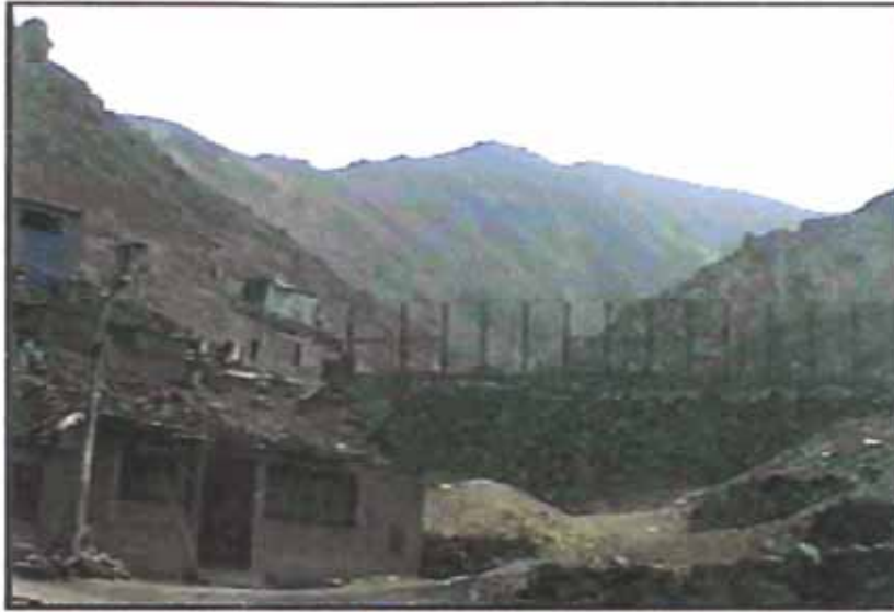
Foto N° 6.10. Muro de pirca conteniendo material de relleno de un campo deportivo del A. H. "Jesús de Nazaret", en un evento sísmico esta estructura colapsaría.
