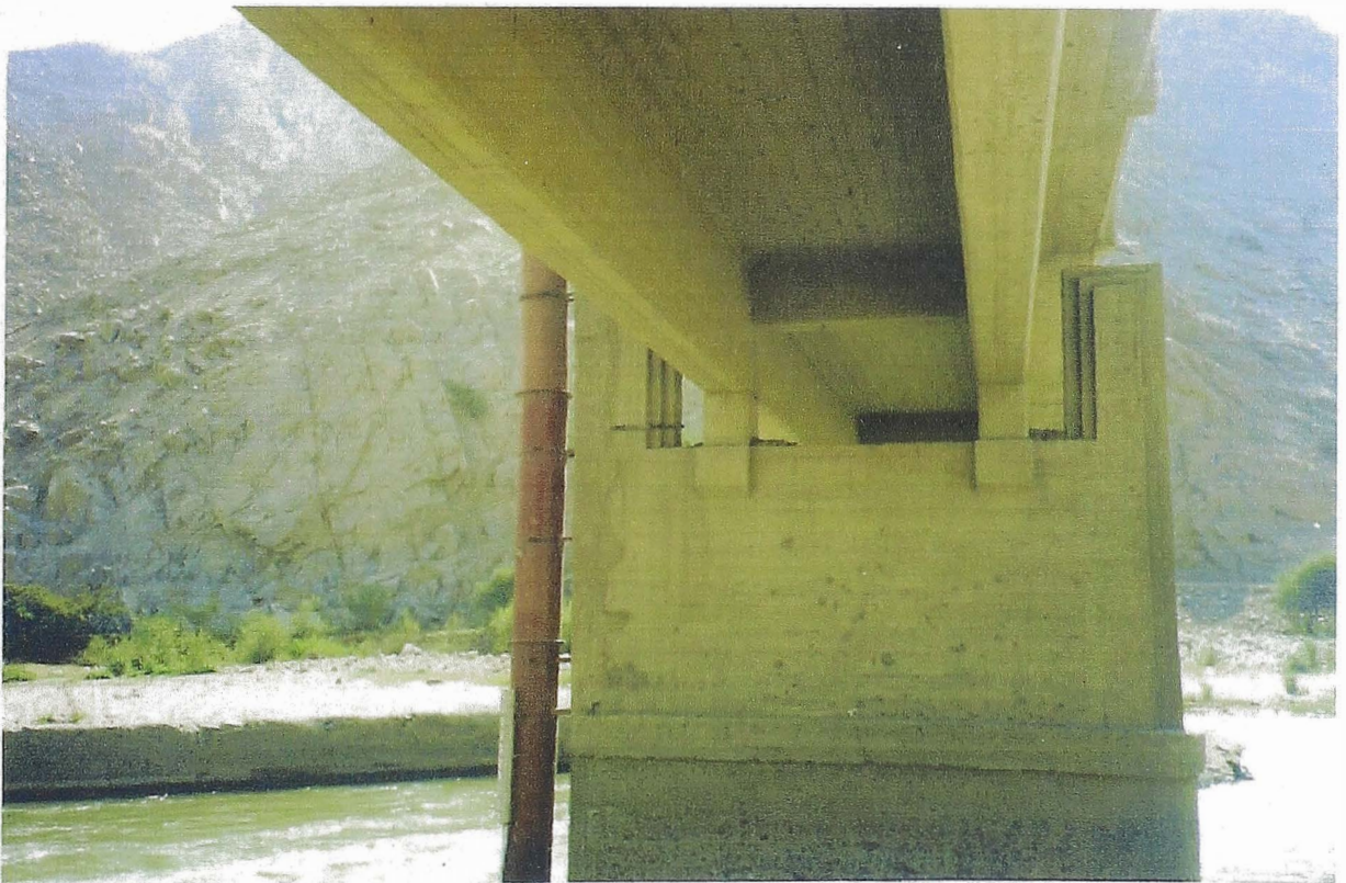
FOTO 8: EN LA FOTO SE OBSERVA UNO DE LOS PILARES, LAS VIGAS LONGITUDINALES, LAS VIGAS TRANSVERSALES Y EL TABLERO DEL PUENTE HUAMANI
