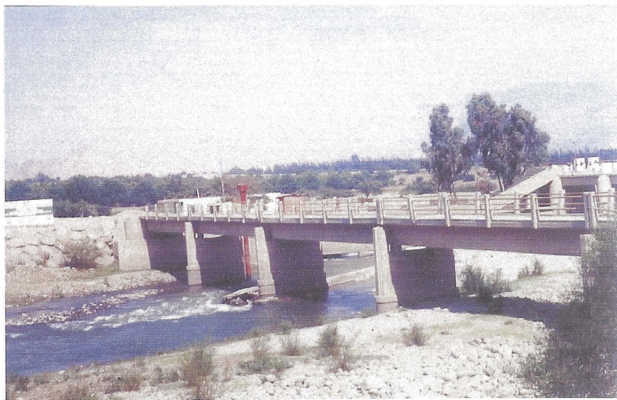
FOTO 4: EN LA FOTO SE OBSERVA LA ESTRUCTURA DEL PUENTE HUAMANI(PILARES, ESTRIBOS, TABLERO); AL FONDO SE VE PARTE DE LA BOCATOMA LA ACHIRANA.
