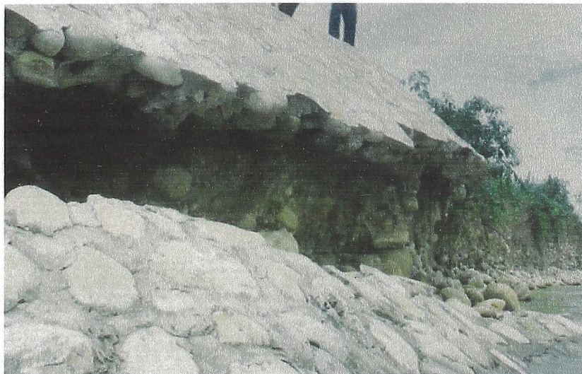
Fotografía 3-3 Desprendimiento de la mampostería al fallar la uña estabilizadora
