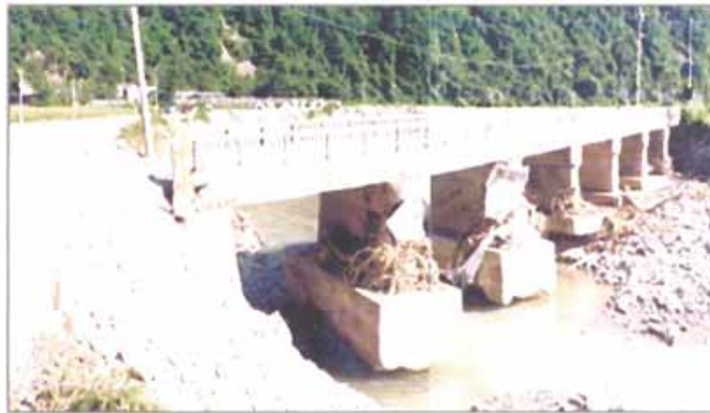
Se observa la erosión en los pilares de un puente.
