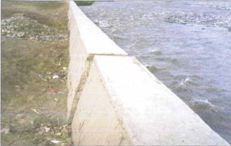
Figura 3. Separación de paño del muro de contención que indica que el muro se está empezando a voltear.
