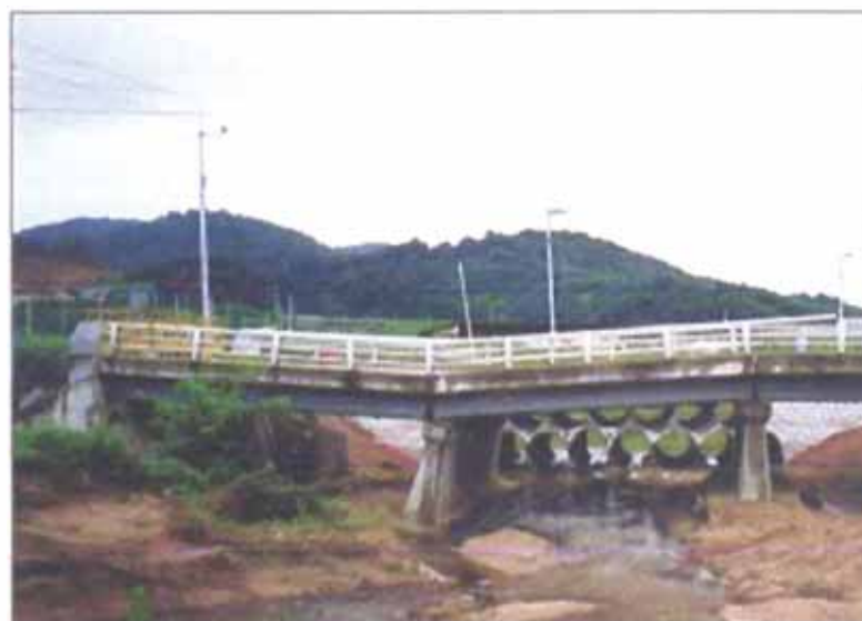
Colapso de un puente debido a la socavación de sus pilares
