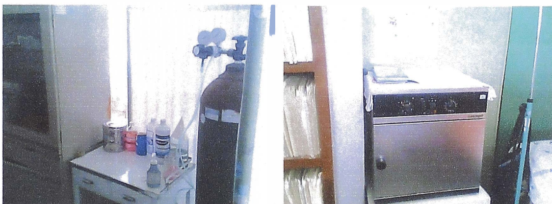
Equipos de emergencia mal ubicados sin la debida protección en caso de un sismo.
