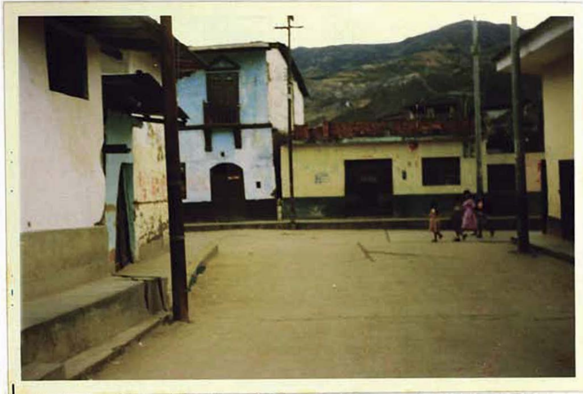
7) Asentamientos de una vivienda en la intersección de Huáscar y Unión observe la separación de 2 viviendas y el deslizamiento del Jr. Unión.
