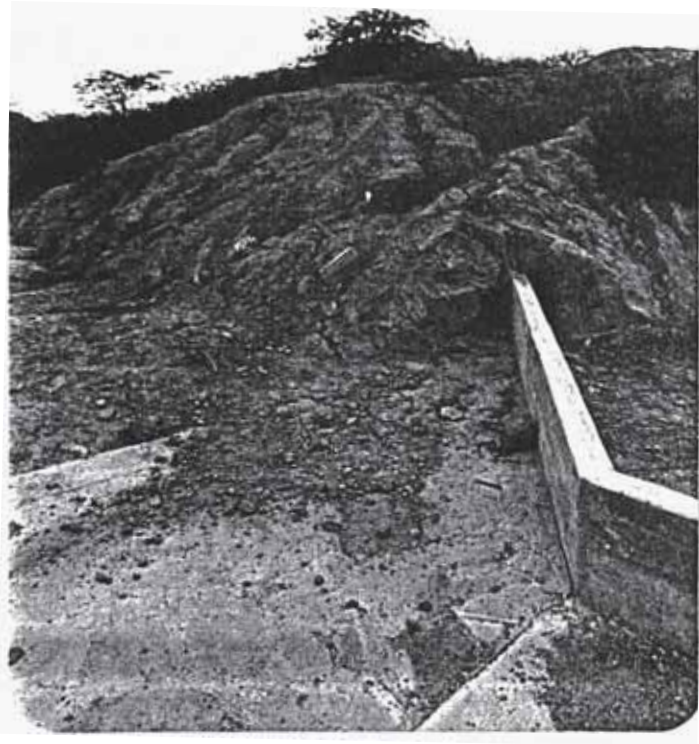
Foto 4.- El suelo de la ciudad predominantemente arcilloso, muchas veces presenta poca consistencia, como se aprecia en la foto.
