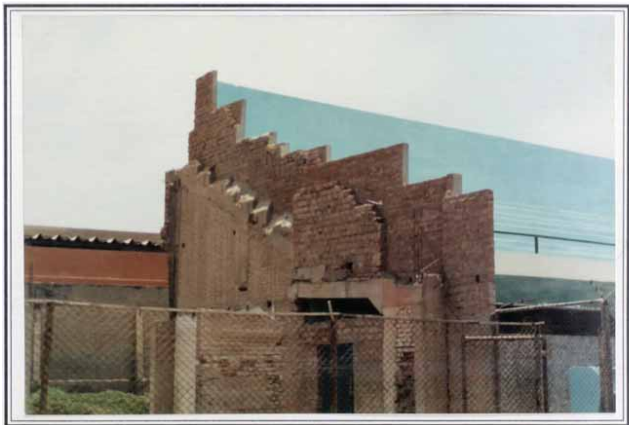
Foto N°36: Estadio Telmo Carbajo. Vista interior de sus tribunas principales. Se aprecia las deficiencias en su construcción y es notoria la antigüedad de sus estructuras.
