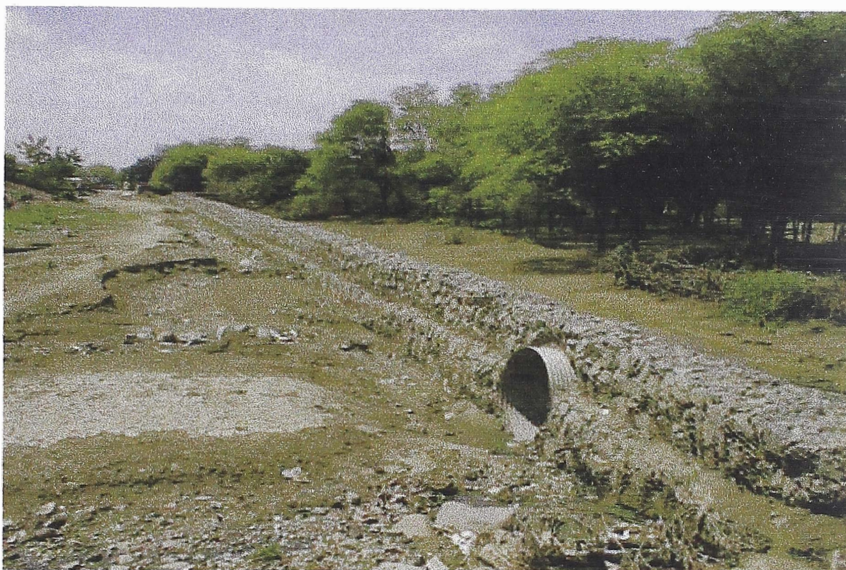
7.- Esta toma es parecida a la anterior, también se aprecia el crecimiento de vegetación tanto en el muro como en el cauce.
