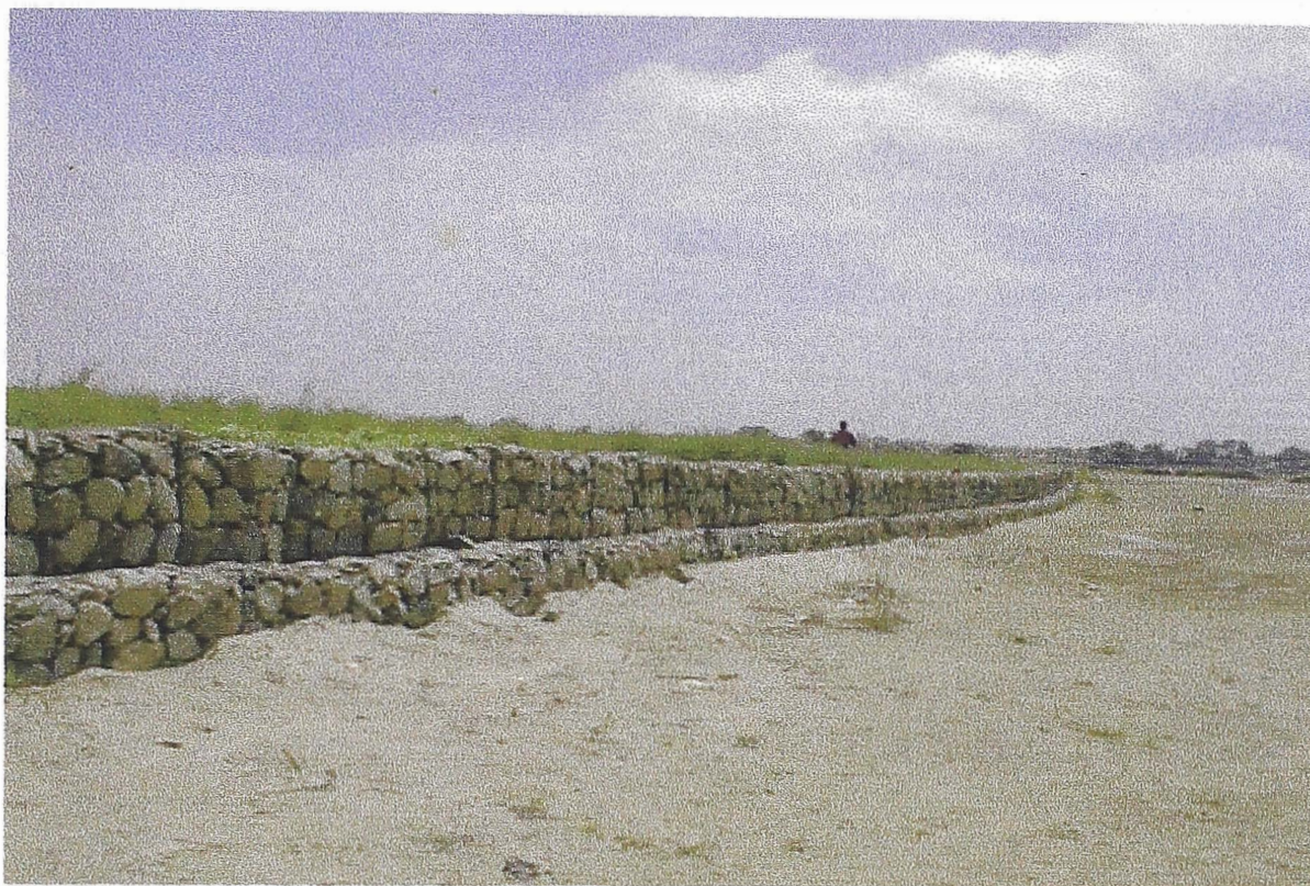
1.- En la vista se muestra el diseño típico de defensas ribereñas con gaviones. Esta toma de corresponde a la margen derecha de la Quebrada Corrales - Tumbes.
