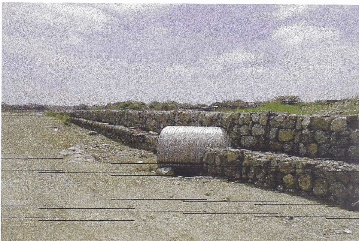
4.- Esta es otra foto tomada desde otro ángulo, del detalle de la alcantarilla que se une con el muro con gaviones.
