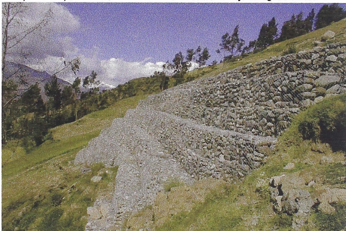
12.- En esta toma se aprecia que no solo los gaviones pueden emplearse en defensas ribereñas. En la toma se ve una estructura de contención con gaviones, ubicado en la ciudad de Pierina en el Departamento de Ancash.
