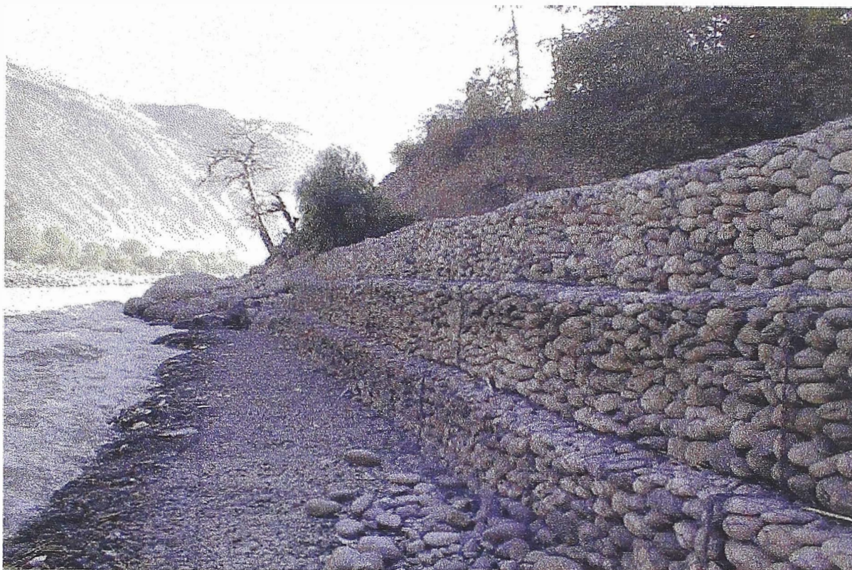
11.- En esta vista se aprecia al muro trabajando con cierto tirante de agua. Defensa ubicada en la margen izquierda del río Casinchihua en Abancay. También se aprecia la típica inclinación del colchón reno debido al flujo del agua en el lecho.
