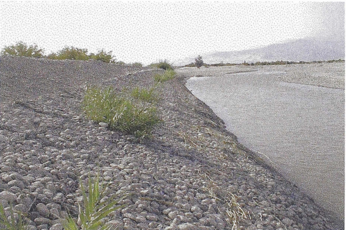
16.- En la vista se muestra un dique con colchones reno en su talud, asimismo también se aprecia el aporte positivo de los gaviones al impacto ambiental. Foto de la defensa de la margen derecha del río Ica.
