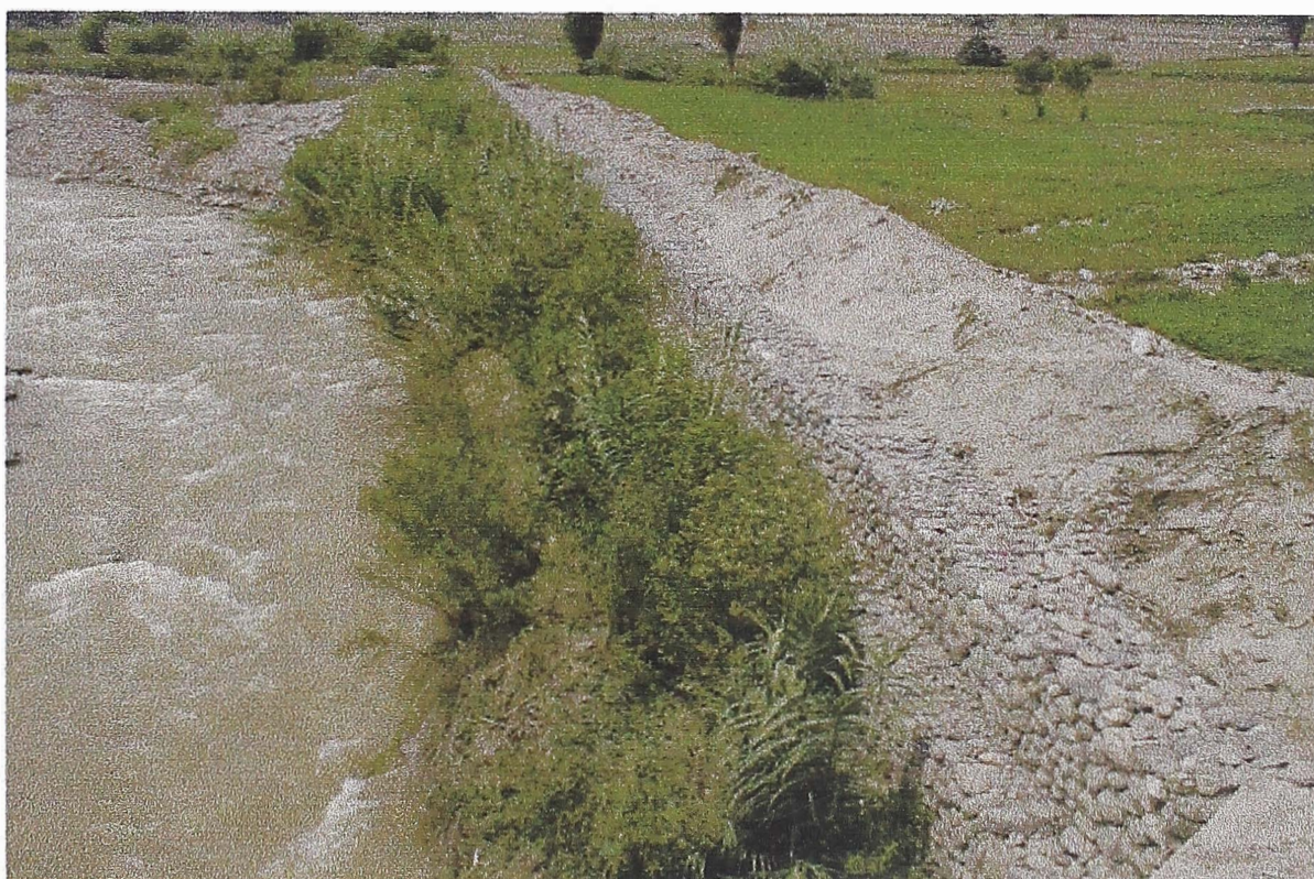
18.- En la toma se muestra la defensa cumpliendo el propósito para la cual ha sido diseñada, asimismo se aprecia la vegetación crecida en dicha defensa.
