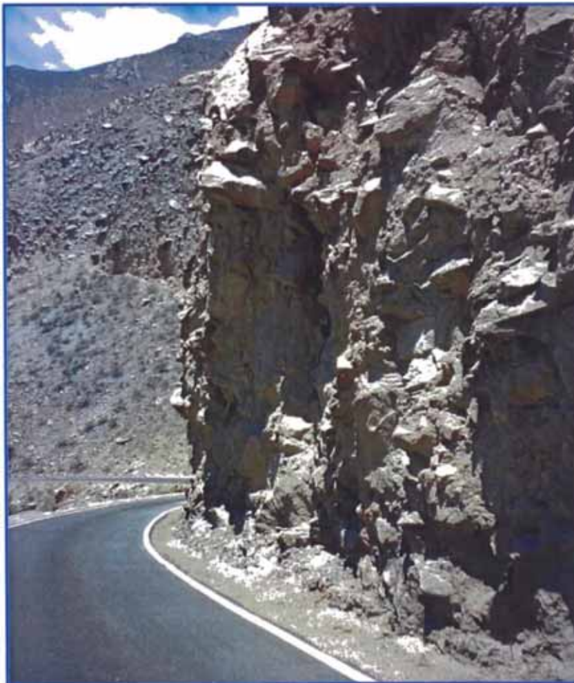
Figura N° 4.04: Talud superior con bloques de rocas propensas a derrumbes.
