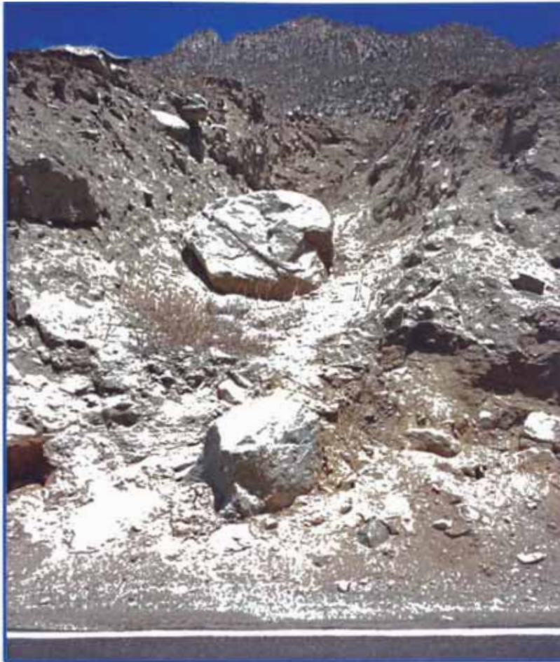
Figura N° 4.07: Presencia de cárcava, que genera escorrentía de aguas sobre la vía.
