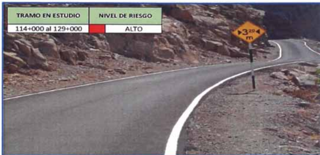
Figura N° 4.08: Tramo con ancho de vía reducido y sin bermas.
