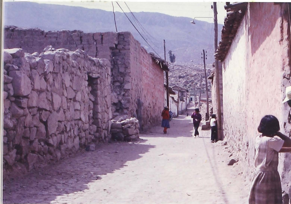
FOTOS 8.2 y 8.3 Notese la altura y ancho de los muros, el daño de las edificaciones por sismos anteriores es evidente, presentan grandes aberturas y grietas en los muros, los techos han colapsado parcialmente. El sismo del 16-02-79 ha producido la destrucción parcial de varias edificaciones y el colapso en algunas. Para el evento próximo se estima el 64% de colapso en Pampacolca y 57.16% en Chuquibamba
