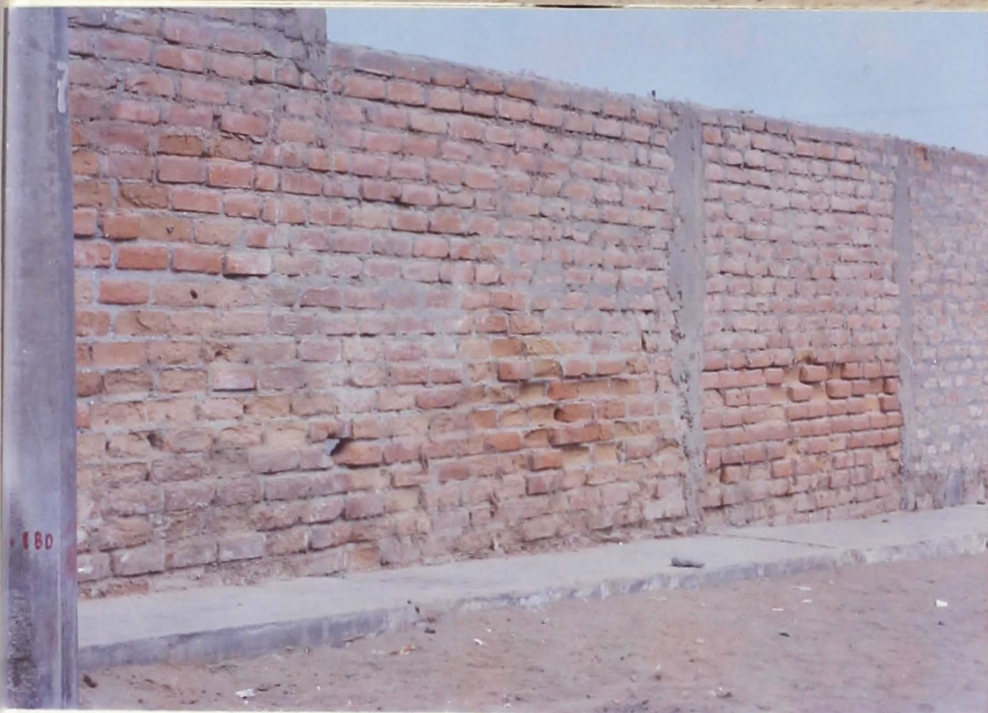
FOTO 5.5 Las paredes no revestidas son atacadas por el ambiente salino reduciendo la resistencia sísmica de la edificación
