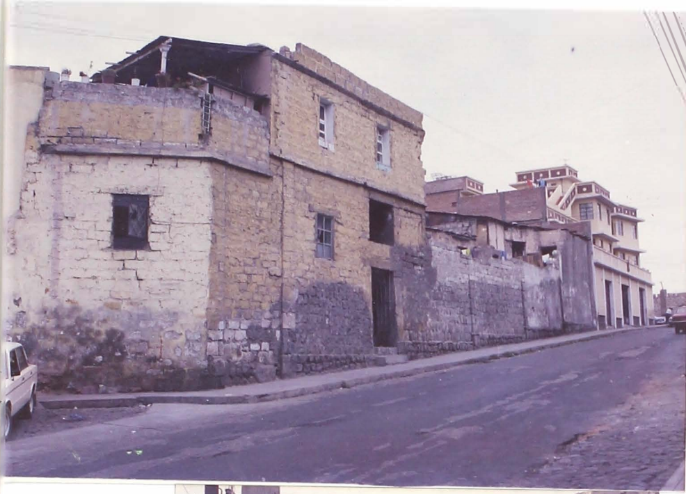
FOTO 9.11 Casonas antiguas como esta albergan a unas 5 familias, construidas de Sillar, carecen de elementos sismoresistentes y están dañadas en general por sismos anteriores.
