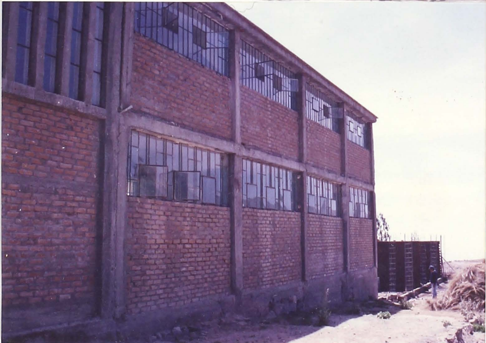
FOTO 8.4 El colegio Nac. Corazón de María en Chuquibamba ha sufrido el asentamiento diferencial y deslizamiento de un bloque en uno de sus pabellones. Nótese la separación en la junta sísmica que ha evitado mayores daños.
