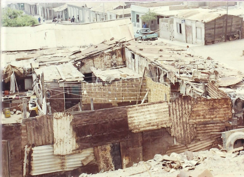
FOTO 6.3 Edif. Tipo 0 Construcción de madera con colapso parcial y reconstruida con materiales de desecho.
