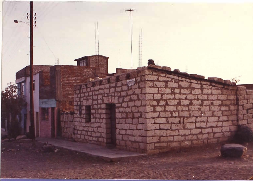
FOTO 9.24 Viviendas de Sillar sin elementos de refuerzo. Techo ligero y flexible, altamente vulnerable a esfuerzos sísmicos
