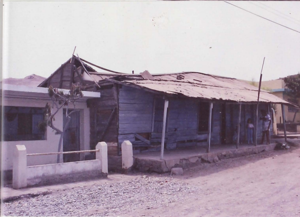
FOTO 6.2 Edificaciones Tipo 0, con colapso parcial por deterioro de sus elementos estructurales (está habitada)
