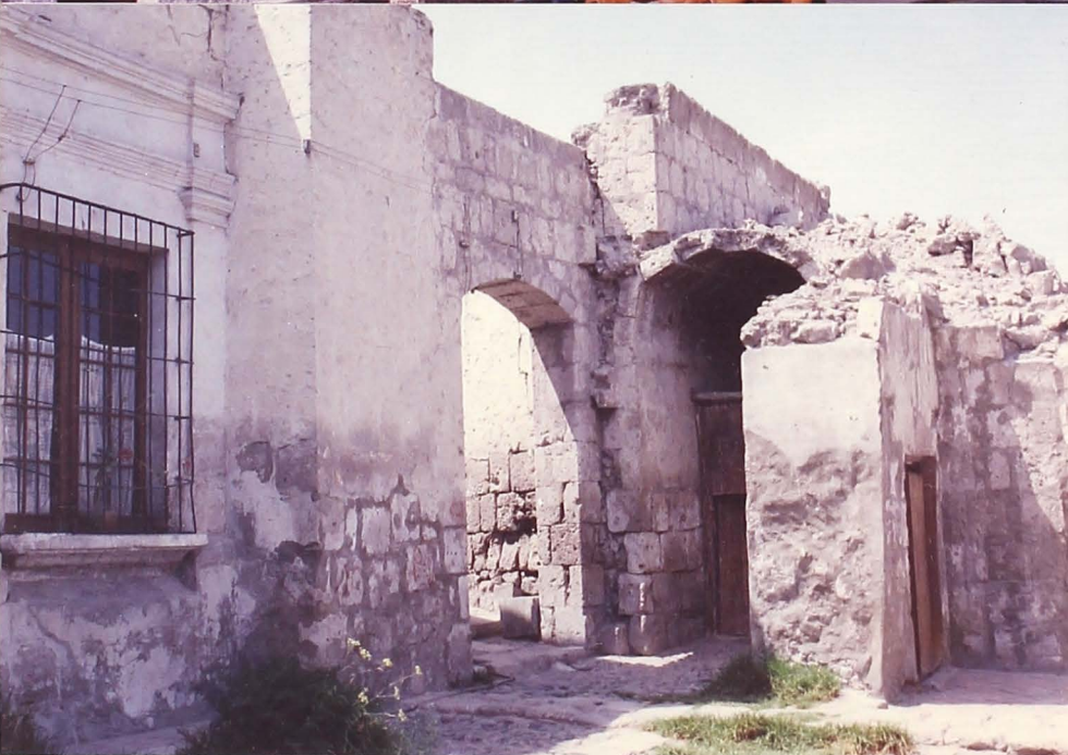
FOTO 9.23 Edificaciones aboveda- das con antigüedades superiores a los 100 años. Los sismos y terremotos han dejado sus huellas.
