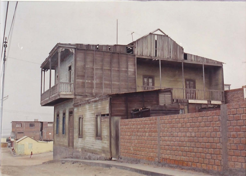
FOTO 5.6 Construcciones tipo 1 (de madera). Por falta de mantenimiento, la humedad, insectos y roedores han causado la degradación en la escala de resistencia sísmica de esta edificación.
