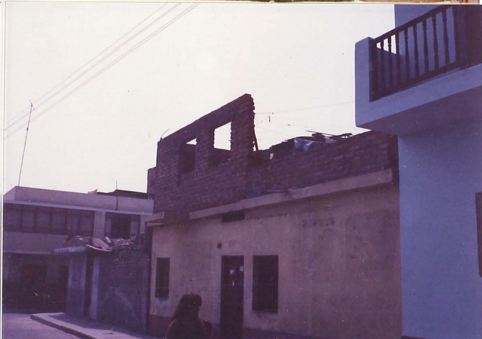
FOTO 9.3 Muchas casas a medio construir tienen muros no arriostrados que podrían caer en un movimiento sísmico.
